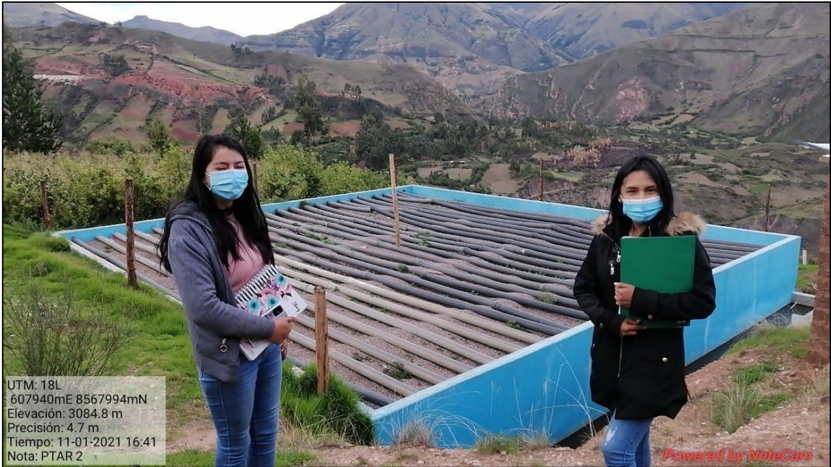
Fotografía 09: Planta de tratamiento de agua potable del Distrito de Tambo.
