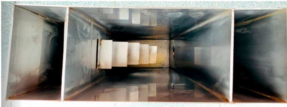
Imagen del interior del tanque de oxidación
