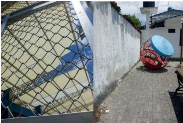
Imagen N°2: Falta de mantenimiento y poca atención
