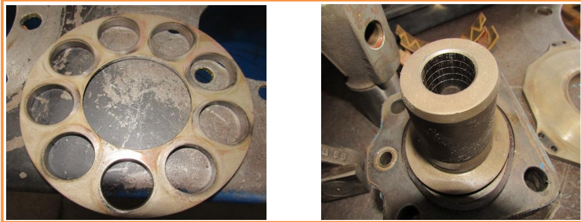
Figura 8: Oxidación de componentes.
