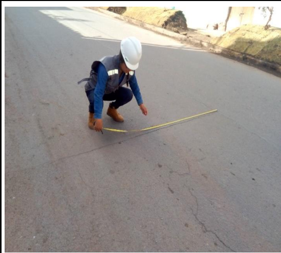
Grietas Longitudinales y Transversales
