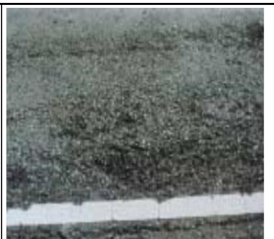
Desprendimiento de Agregado
