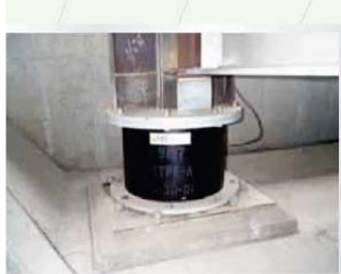
Aisladores en el Long Beach 911 Center no requiere protección contra el fuego.
