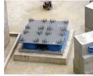
Grupo de cuatro aisladores están ubicados debajo las columnas con mucha carga en el Centro Medico Tan Tzu.
