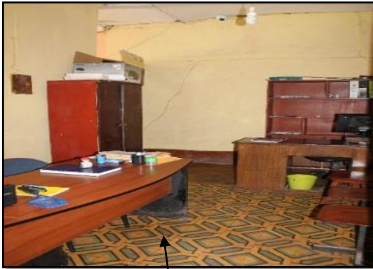
Fotografía N° 13 Gerencia Municipal Área de 11.12m 2 . paredes de adobe, techo barro con caña y piso de mosaico. Fuente: Propia
