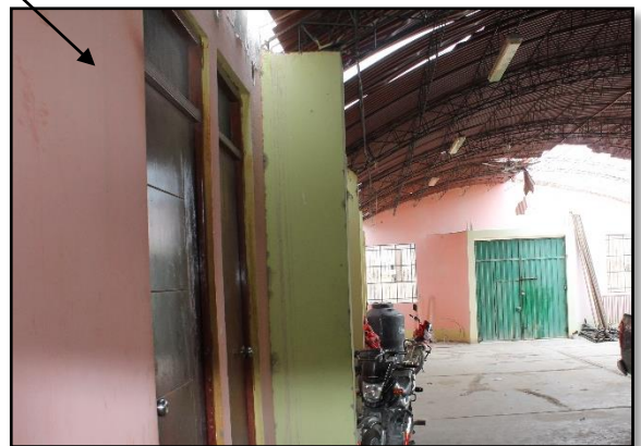
Fotografía N° 26 Salón de Usos Múltiples Se muestra las paredes y pisos en mal estado Fuente: Propia
