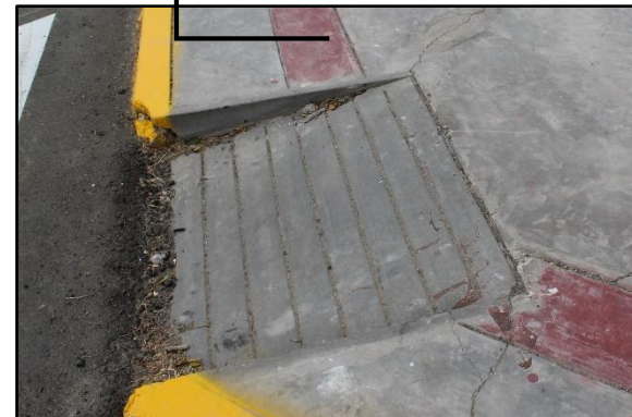
Fotografía N° 33. Rampas de acceso en mal estado y veredas con presencia de rajaduras que dificultan la transitabilidad de los peatones y los usuarios con discapacidad. Fuente: Propia.
