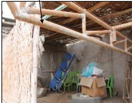
Fotografía N° 30 Almacén El techo con caña en mal estado. Fuente: Propia
