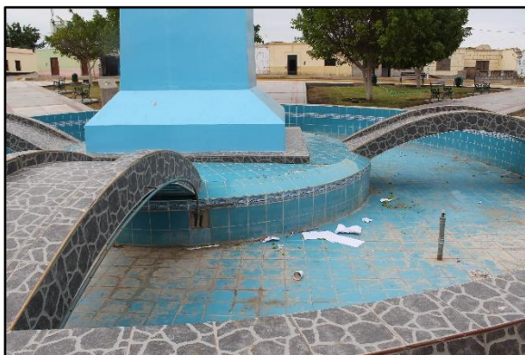
Fotografía N° 32. Pileta central en mal estado de conservación, inoperativo y sin mantenimiento, propiciando la contaminación a través de la acumulación de basura. Fuente: Propia
