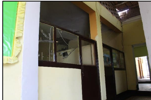
Fotografía N° 3 Las oficinas no cumplen las condiciones mínimas habitables. Fuente: Propia
