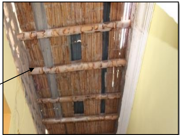
Fotografía N° 24 Salón de usos múltiples Se muestra el techo de caña y barro en mal estado a punto de colapsar. Fuente: Propia
