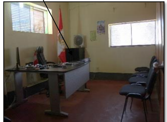
Fotografía N° 23 Tesorería y Abastecimiento Area de 16.94 m 2 paredes de adobe, techo de caña con barro y piso de cemento pulido. Fuente: Propia
