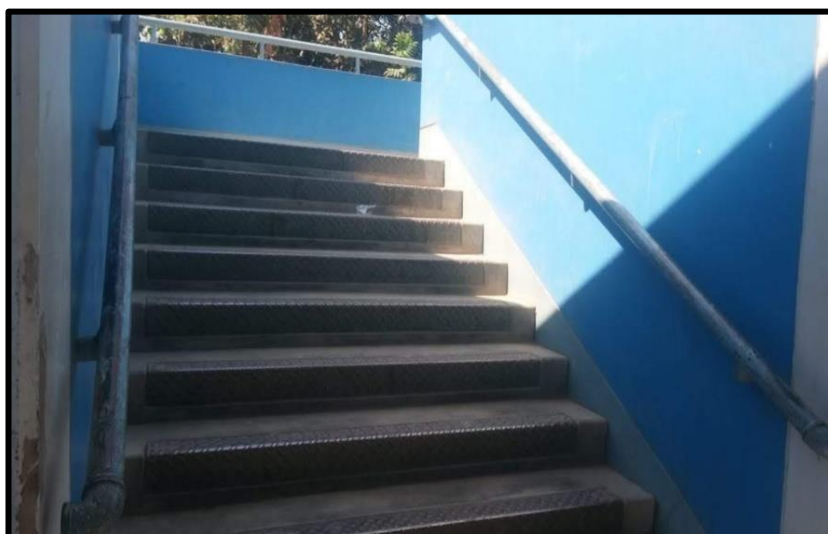
Figura 11: Escaleras sin señalización de la institución educativa
