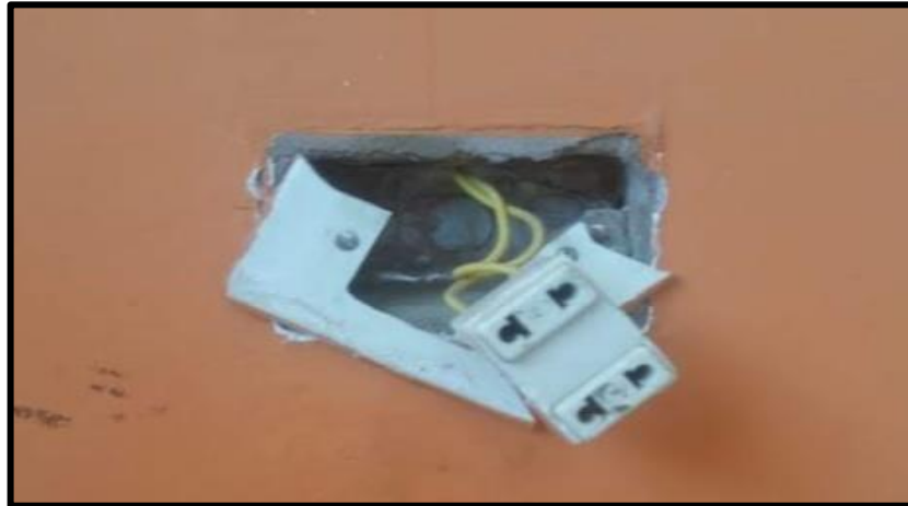
Figura 9: Instalaciones eléctricas en mal estado
