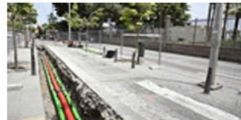
RED ELECTRICA EN TIERRA
