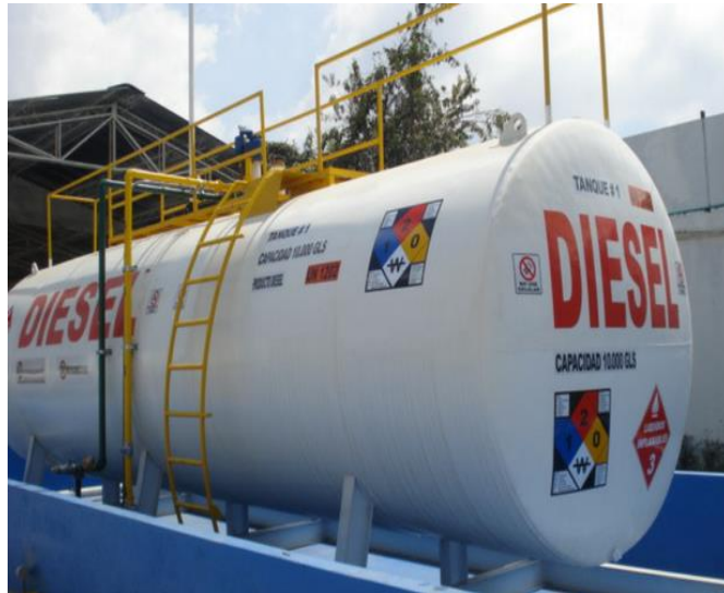
Figura 3. Tanque de Almacenamiento Horizontal.
