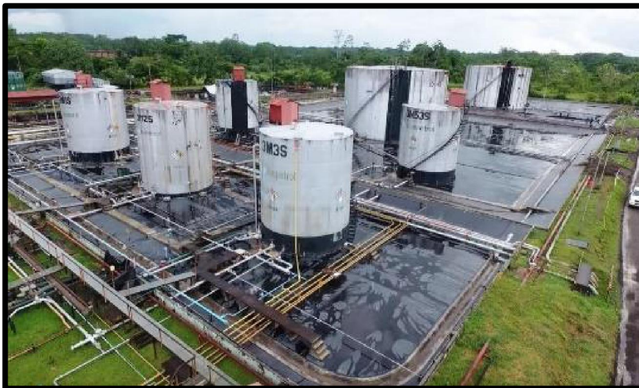
Figura 1. Tanques de Almacenamiento de crudo-Batería 01.
