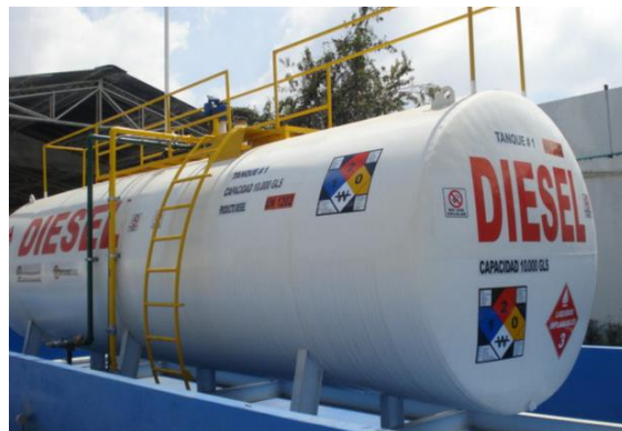
Figura 3. Tanque de Almacenamiento Horizontal.
