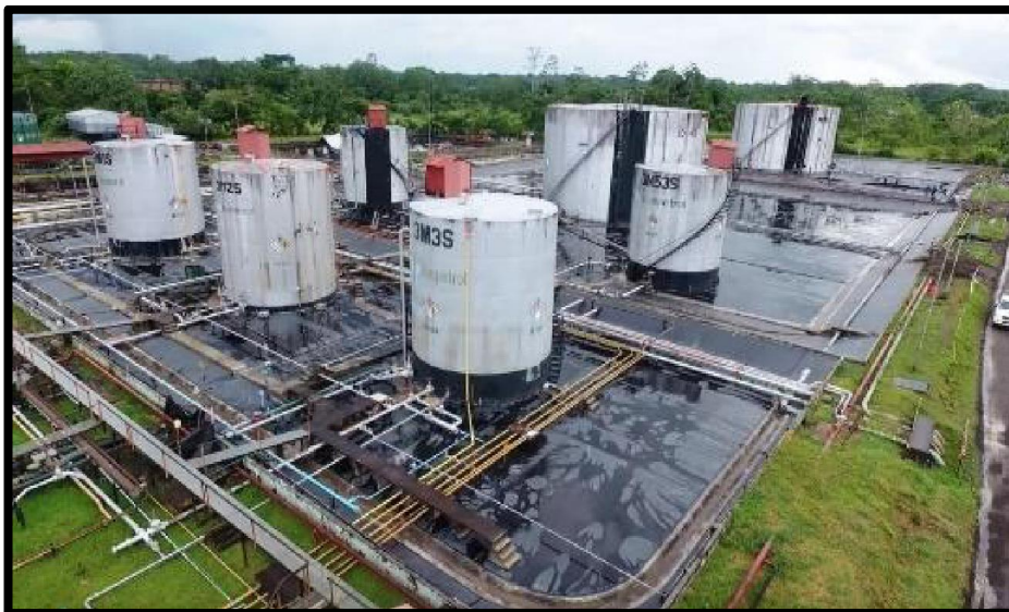
Figura 1. Tanques de Almacenamiento de crudo-Batería 01.
