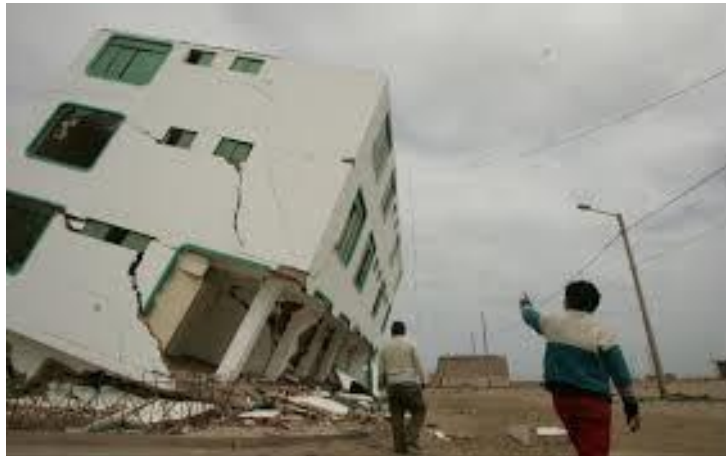
Institución educativa colapsada en el sismo de Pisco
