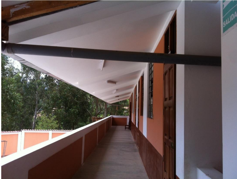
VISTA N° 03; Vista pasadizo del segundo nivel la estructura de la I.E 82109 San Antonio Plan Tual
