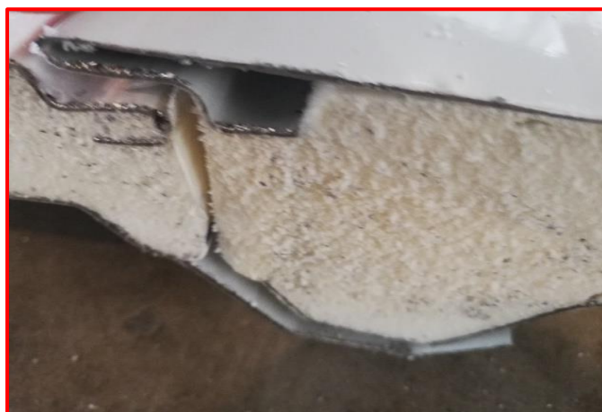
Figura 37. Defecto presentado en el traslape
