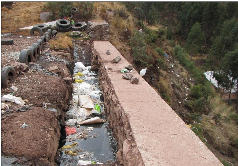
Fotografía N° 04: Presencia de un muro de contención al pie del Botadero, en el mismo se evidencia la presencia de lixiviados.
