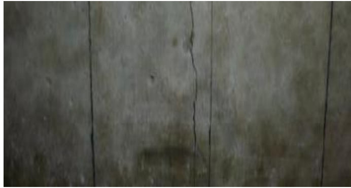
Muestra con falla de la viga a una dosis de 3kg/m 3
