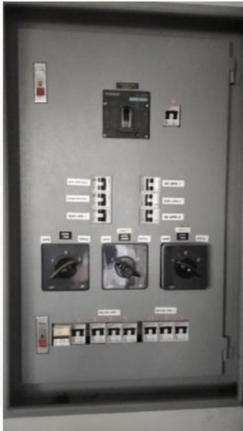
Figura N.º 17: Tablero Eléctrico Fuente: Elaboración propia
