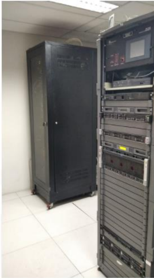
Figura N.º 29: Rack 1 y Rack 2
