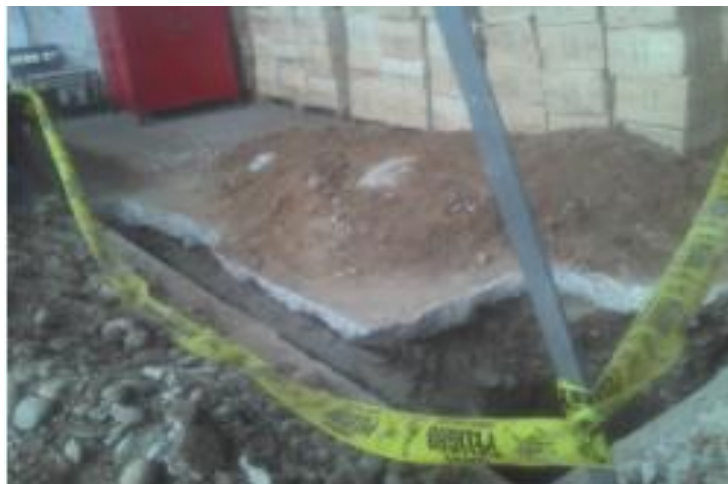
Figura N.º 18: Pozo tierra Fuente: Elaboración propia
