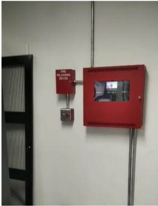
Figura N.º 13: Tablero de control de Sistema contra incendio
