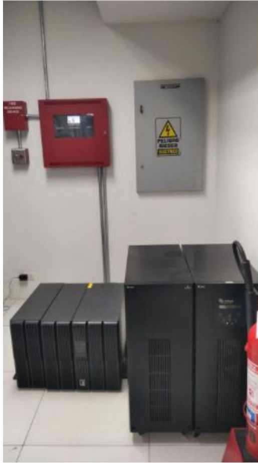
Figura N.º 30: UPS y TABLEROS
