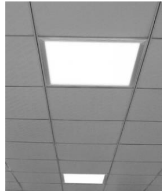
Figura 83: Iluminaria interior empotrada.
