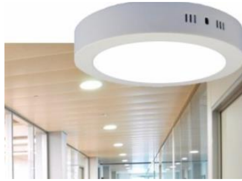
Figura 81: Iluminaria interior empotrada.
