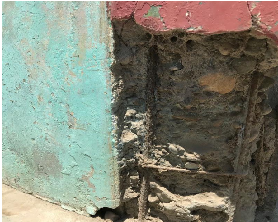
Acero de refuerzo expuesto a la intemperie y corrosión.
