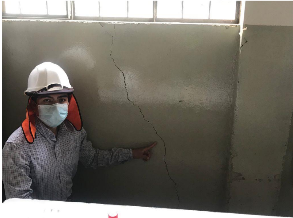
Presencia de grietas en los muros.
