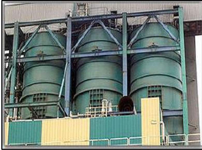
Figura 15: Silos almacenadores de carbón. Adaptado de Engie, 2016.
