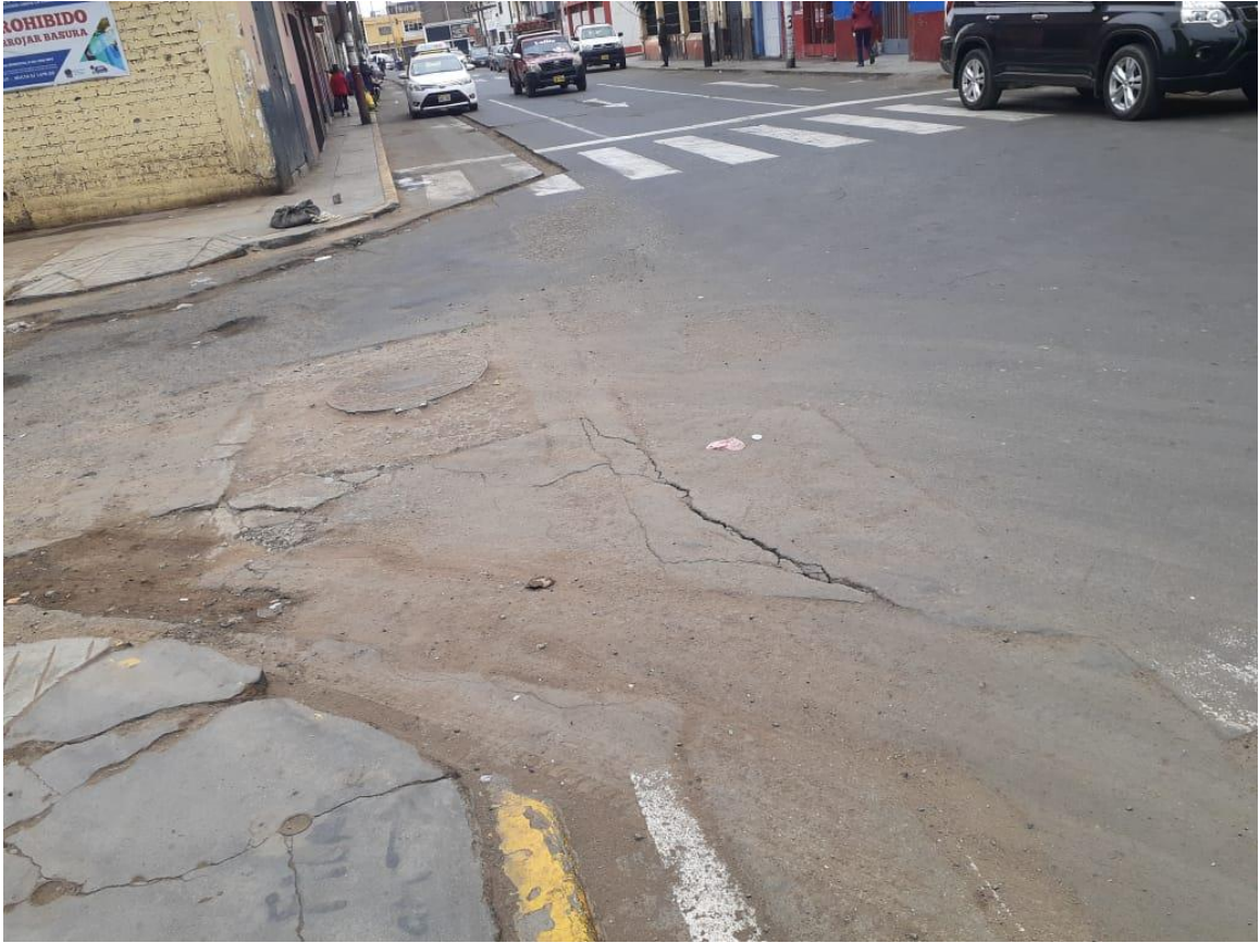
Figura 5: desprendimiento de agregado y hundimiento
