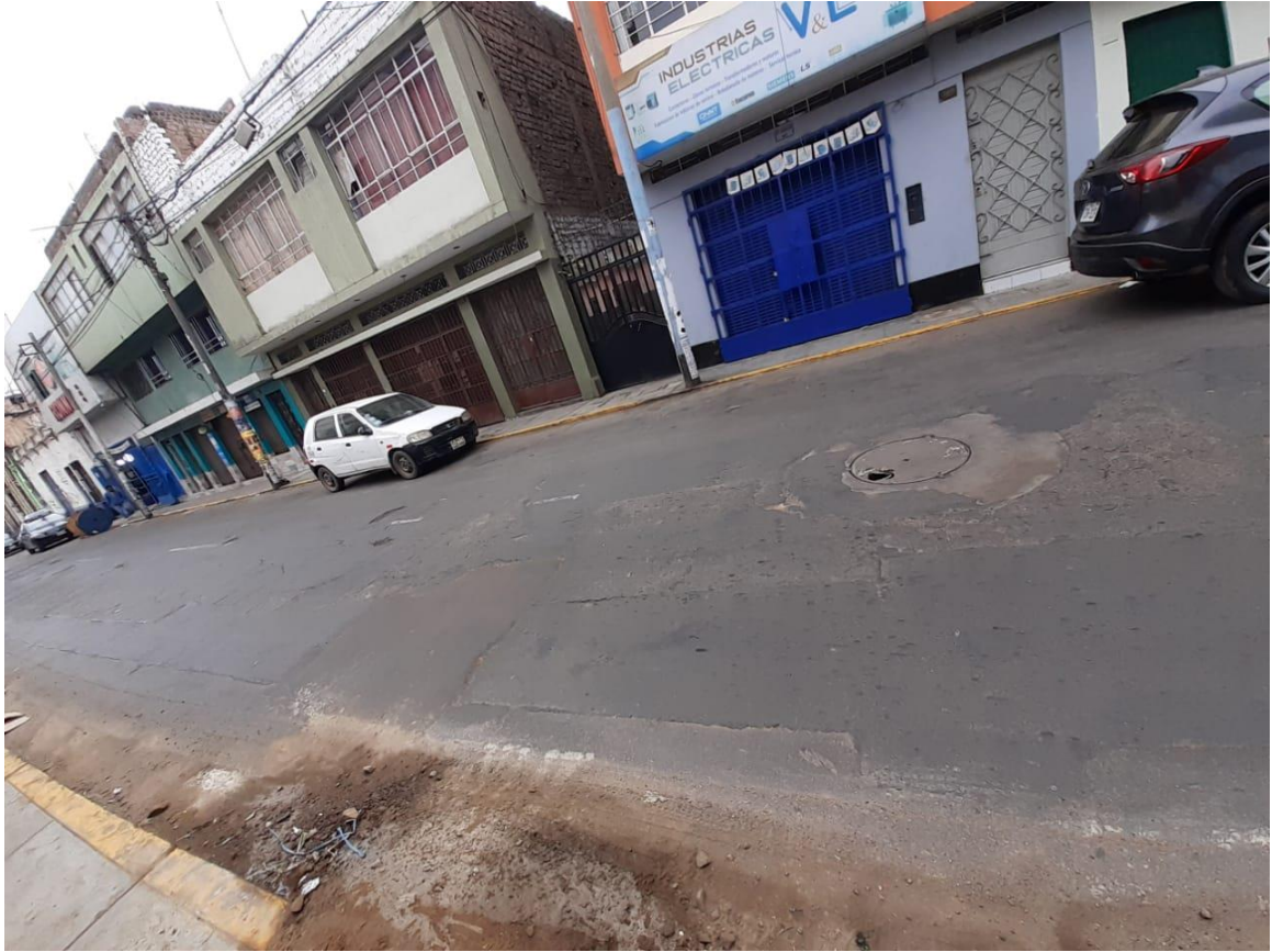
Figura 10: Desprendimiento de agregado y huecos
