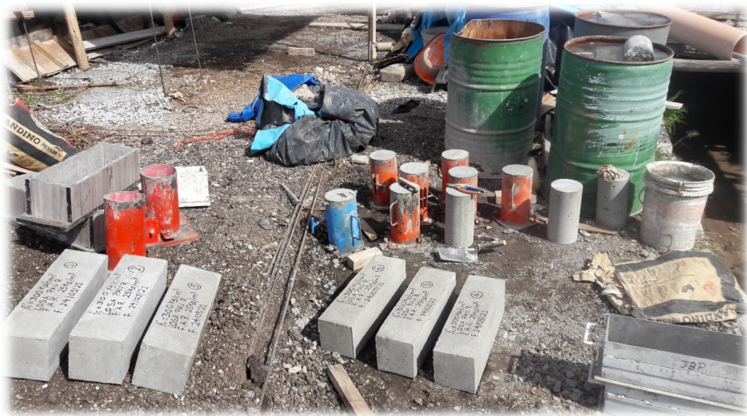
FOTO 13: Materialización de datos en las briquetas prismáticas (viga)
