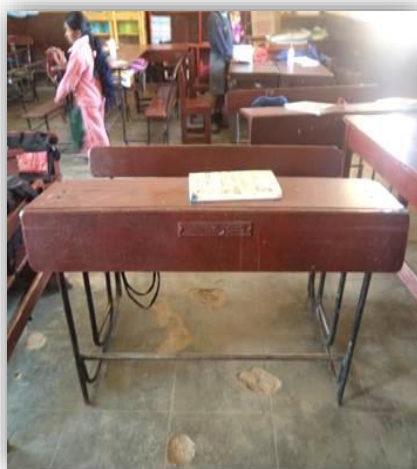
Figura 11. FOTO 3 - I.E. N° 80130 Emérita Herrera Vega, Paranshique - Huamachuco, Elaboración propia – vista de pisos deteriorados.
