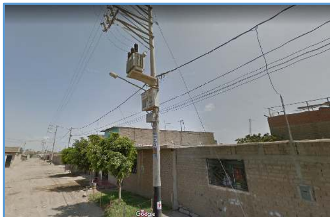
Figura 17. Subestación Eléctrica, Alumbrado Público y conexión eléctrica domiciliaria en el Pueblo Joven Ampliación Fanny Abanto.
