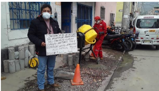
Fotografía N° 31: Preparación de la mezcla usando el cemento andino, arena gruesa cantera Cachi, piedra chancada ¾ cantera Chacco y agua de las 04 fuentes
