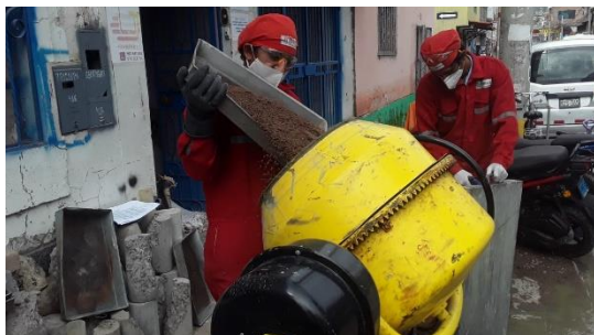
Fotografía N° 39: Personal de laboratorio INGEOMAX vaciando arena gruesa a la mezcladora experimental para el preparado de la mezcla con el agua de la laguna de Yanayacu
