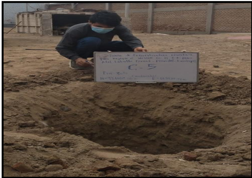
Figura 5. Vista de Calicata C-05 con una profundidad de 3m. en la I.E Pedro Abel Labarthe Durand, Sede Pimentel
