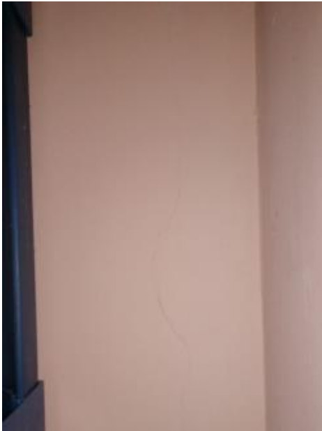
Fisura en paredes (B-27)
