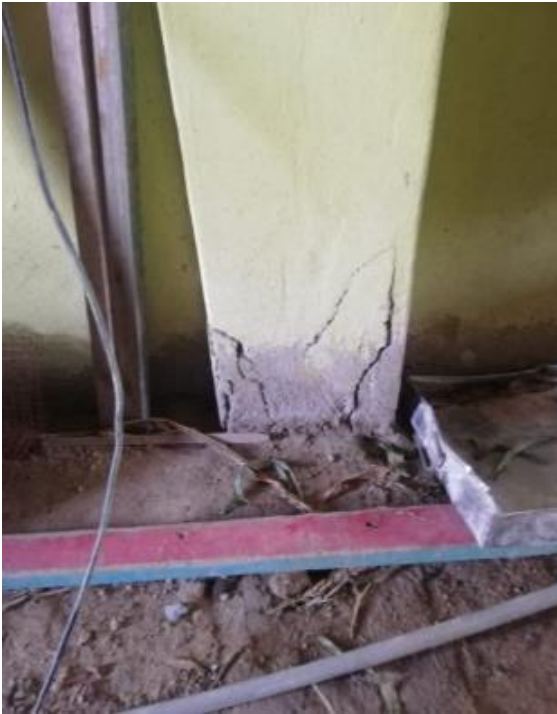
Agrietamiento de columnas (D-19)
