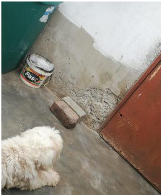
Desmoronamiento de paredes (C-22)
