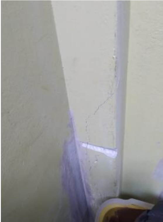
Fisura en la columna (C-12)
