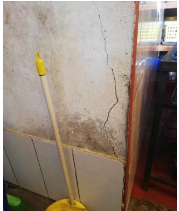
Fisuras de las paredes (C-22)
