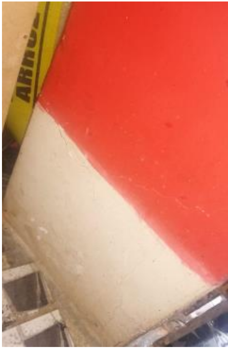
Fisura en columna (B-27)
