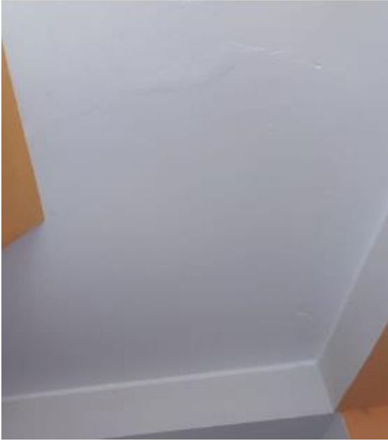
Fisura en el techo (D-23)
