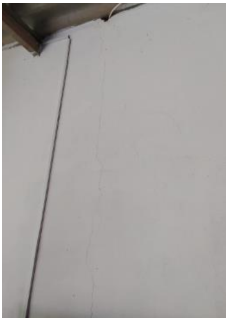
Fisura en paredes (B-21)
