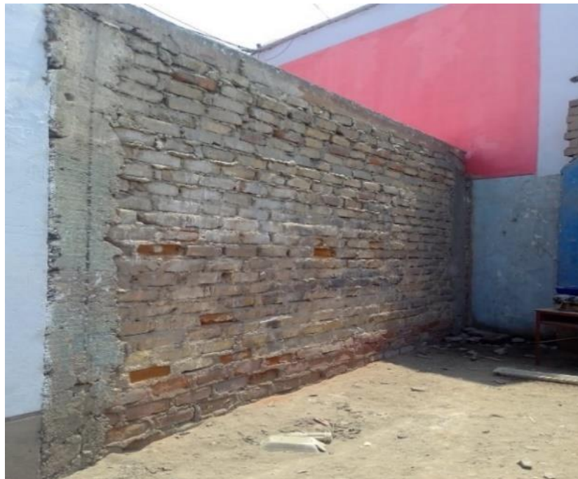
Figura 8: Muro con presencia de sales
