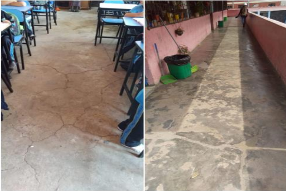
Figura 9: Presencia de fisuras en piso de losa aligerada del segundo nivel
