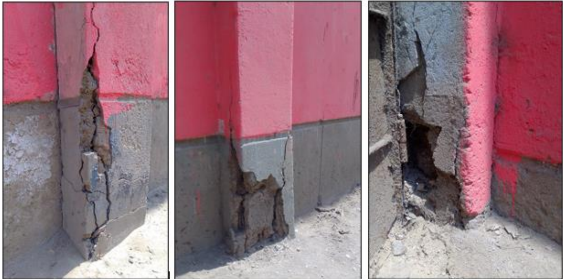
Figura 7: Columnas con desprendimiento de material
