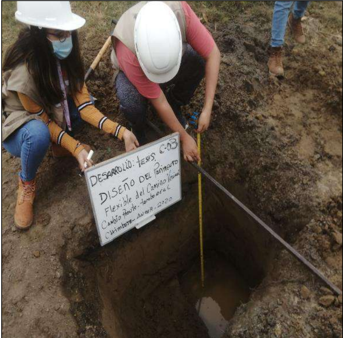
Figura 19: Filtración de agua en calicata 03 hasta 1.50m
