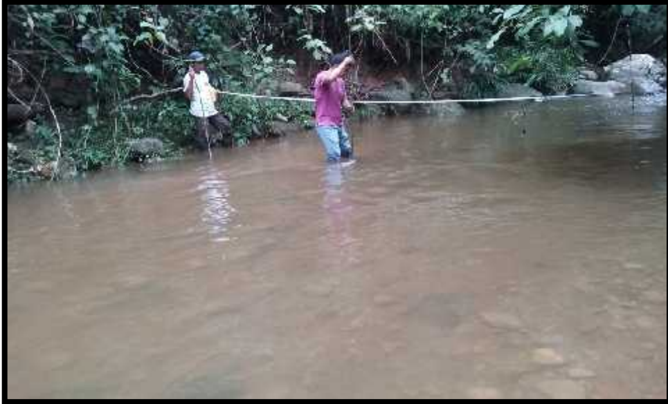
Imagen 16: Captación de la fuente Ishichimi
