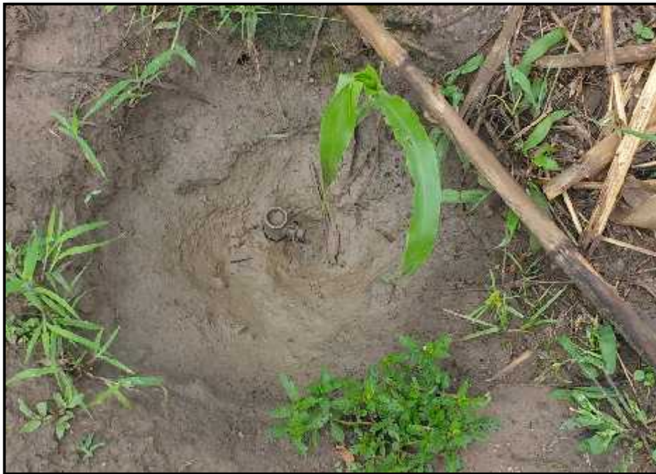
Imagen N° 04: Vista de la estructura de la Válvula de Aire se encuentra sin su caja de concreto que lo protege.
