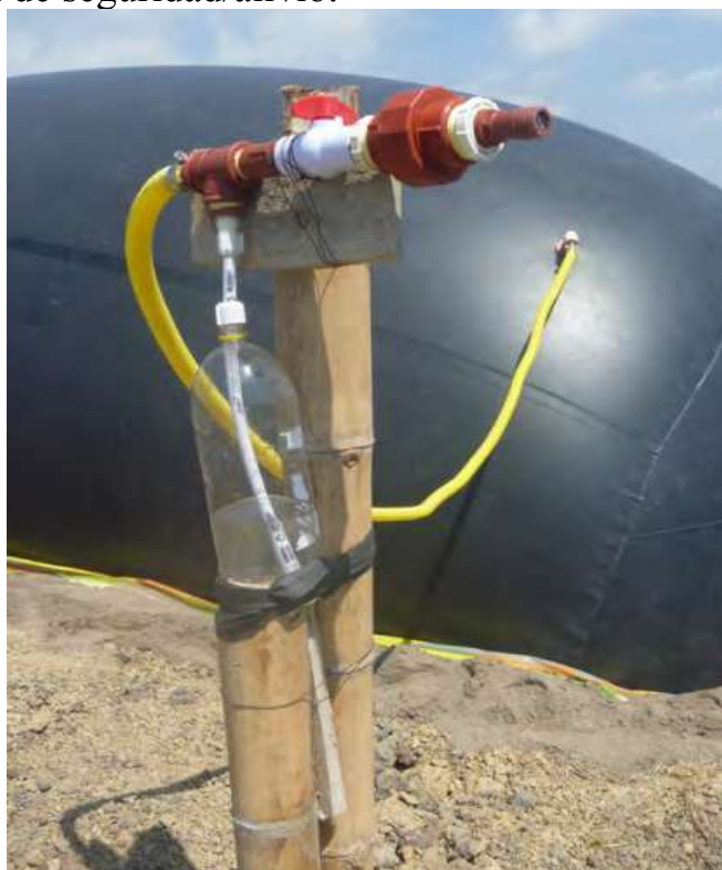
Foto 04: Válvula de seguridad/alivio.
