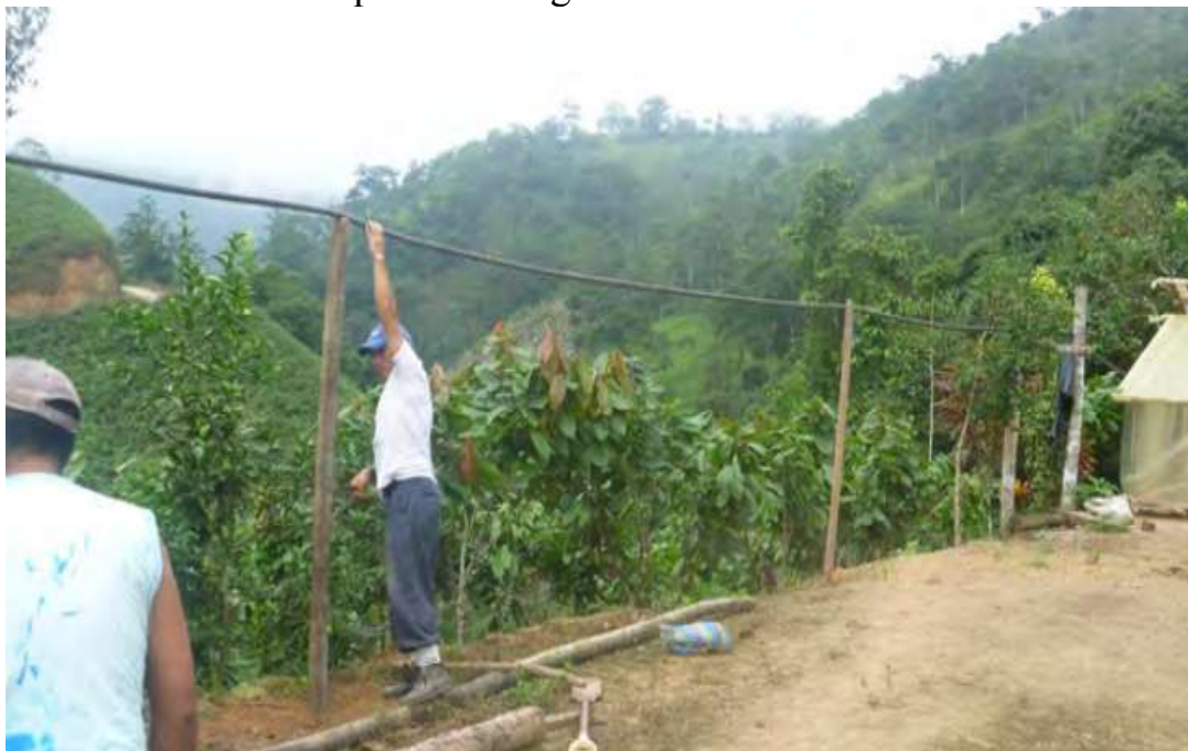
Foto 03: Líneas de transporte de biogás.
