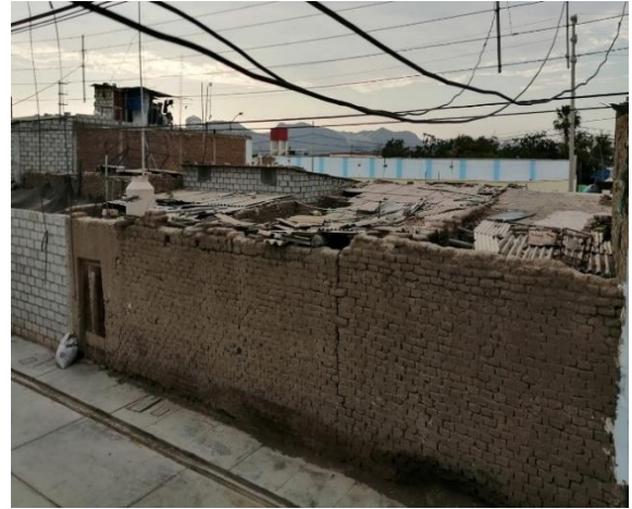
Figura 8. Techos de las viviendas en mal estado.
