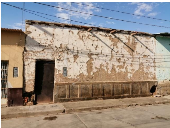
Figura 11. Viviendas de adobe del 1 nivel que presenta daños en sus paredes.
