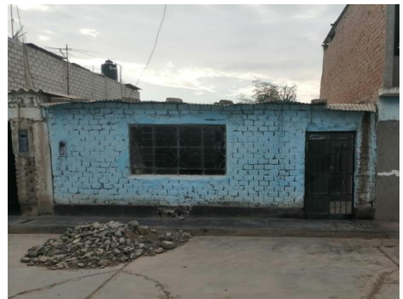
Figura 12. Vivienda de un nivel con su techo en un mal estado de conservación.
