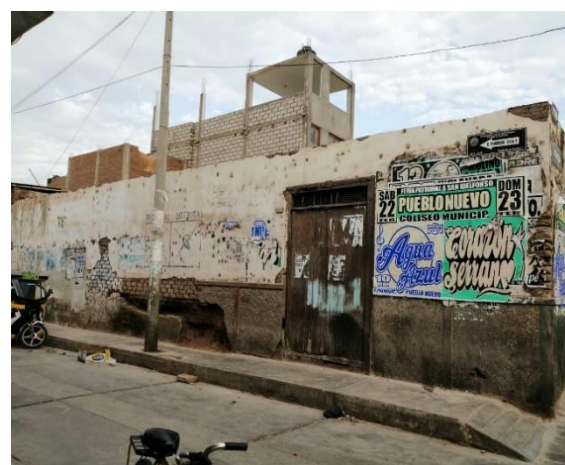
Figura 6. Viviendas en mal estado
