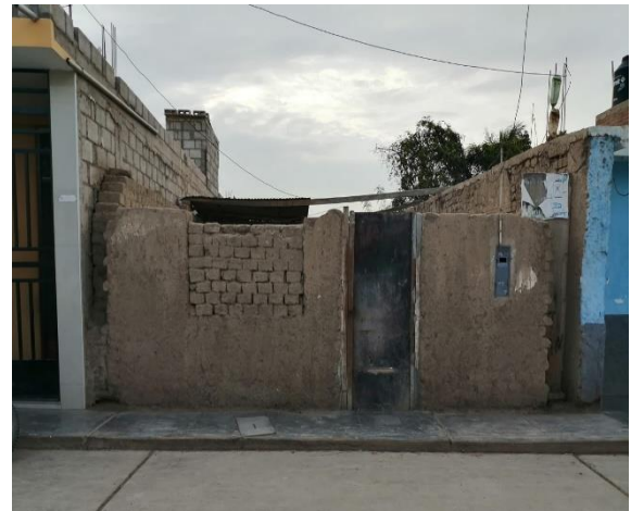
Figura 10. Vivienda en condición precaria
