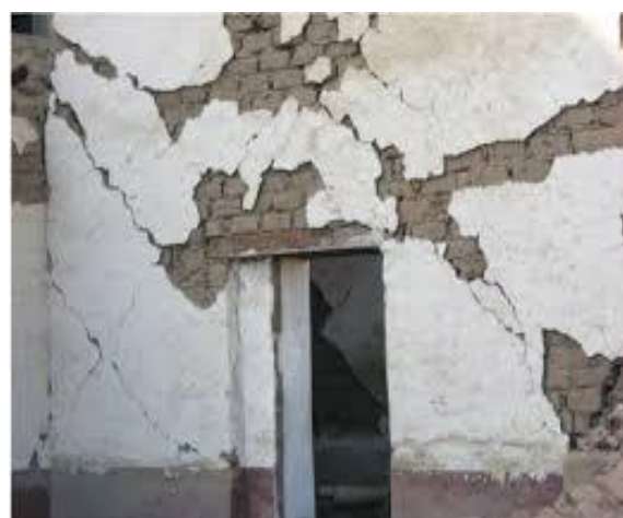
Figura 5. Viviendas con grietas
