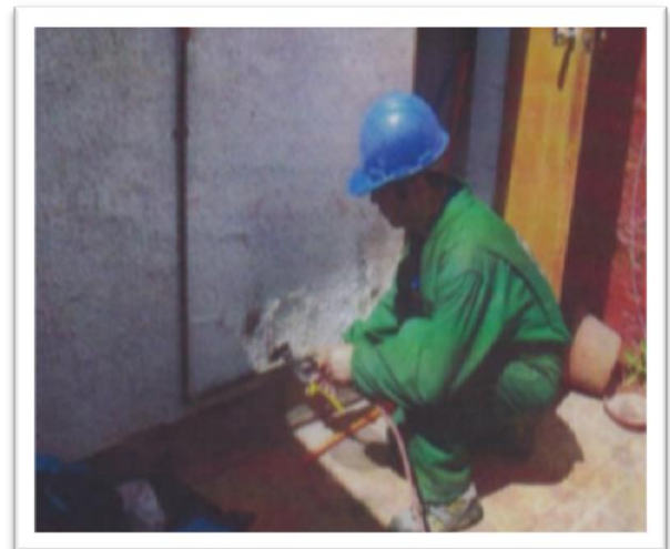
FIGURA 04. SERVICIO DE GASFITERÍA
