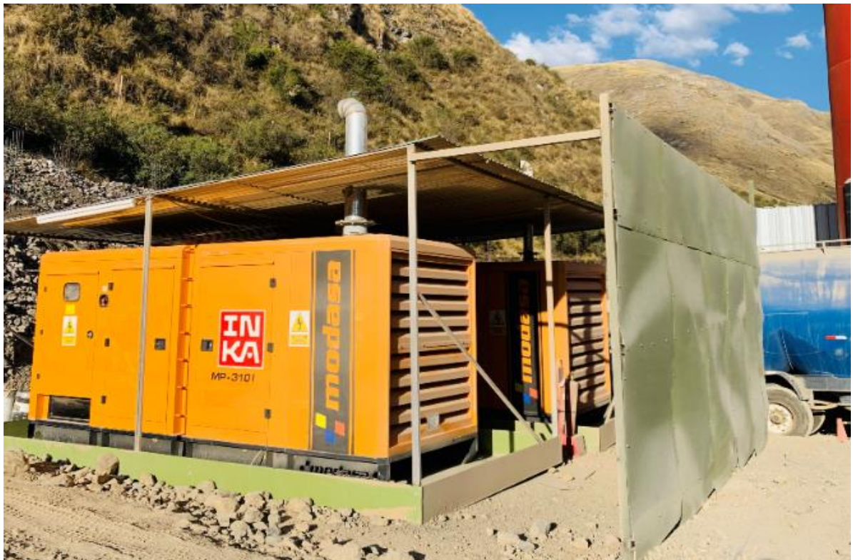
* Confinamiento de estructuras a los grupos electr6genos
