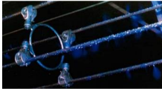
Figura 3 Imagen de efecto corona en conductores quádruplex. Fuente: Circuito globe eléctrica 4U
