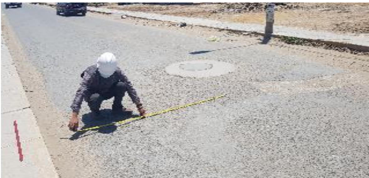
Fotografía 3: UM 11 tramo I izquierda, progresiva 1+320 (Abultamiento y hundimiento).
