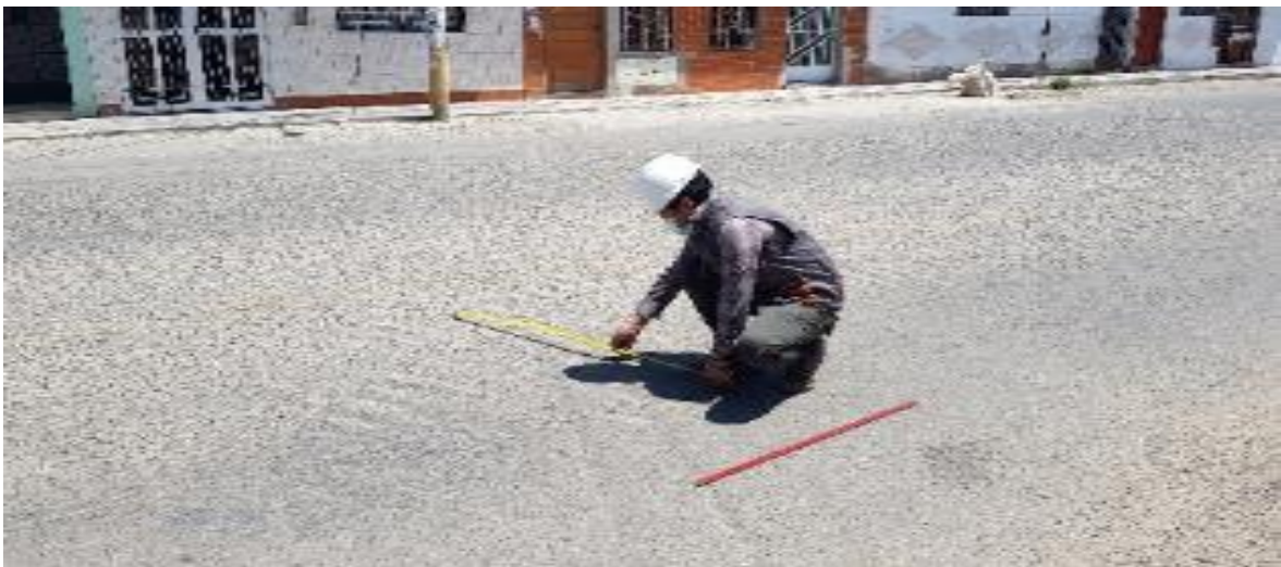
Fotografía 02: UM 04 tramo I izquierda, progresiva 0+396 (Grietas longitudinales).
