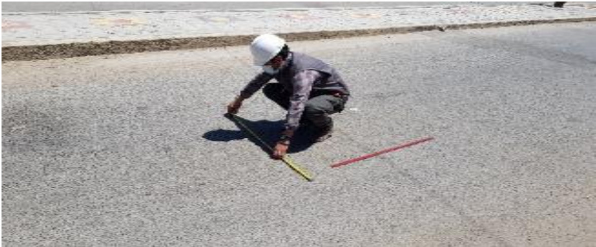
Fotografía 1: UM 02 tramo I izquierda, progresiva 0+132 (Piel de cocodrilo).
