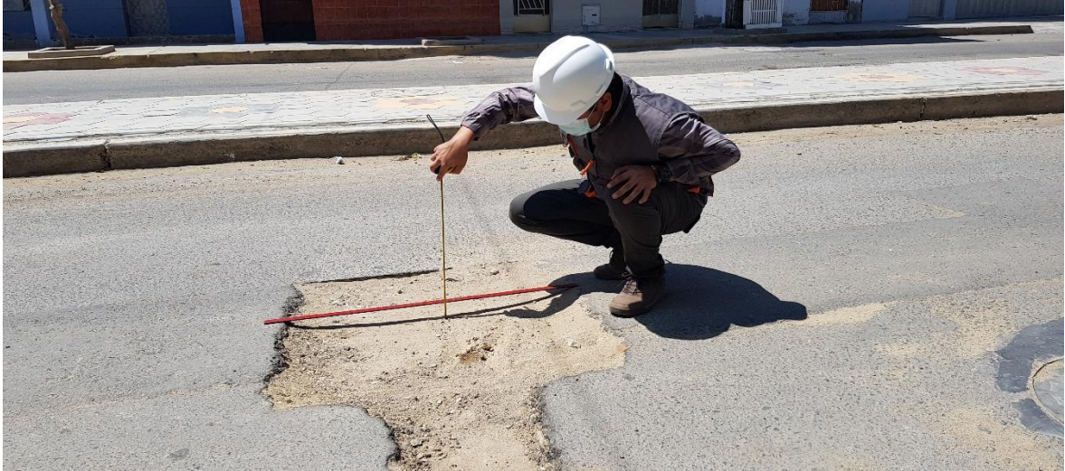
Fotografía 4: UM 02 tramo II derecho, (Huecos/Baches).
