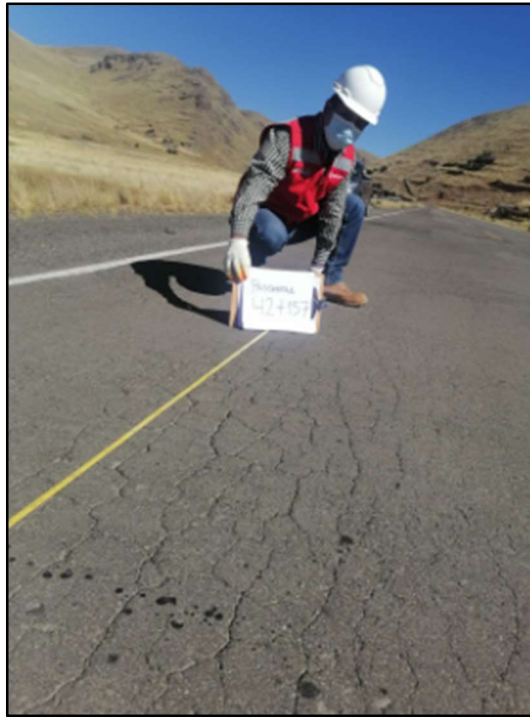
Figura 8: Identificación de falla estructural km 42+157
