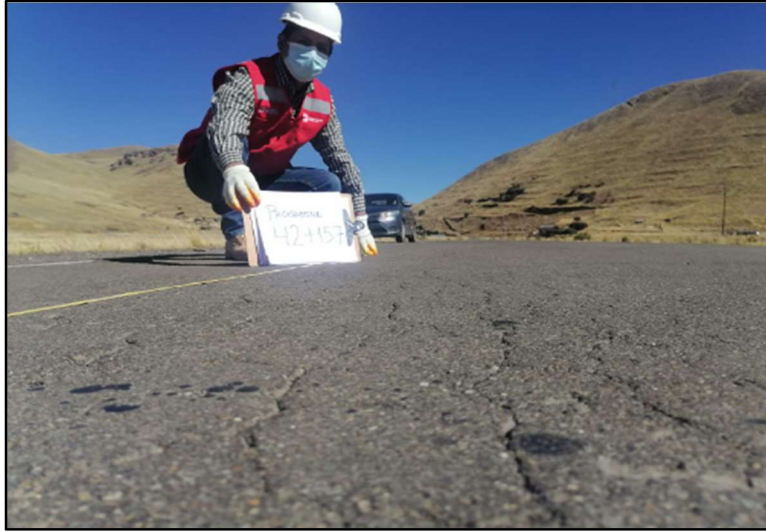
Figura 7: Fisuras longitudinales en el carril
