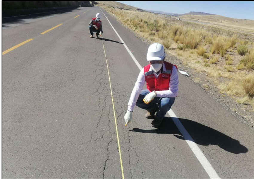
Figura 2: Desprendimiento estructural de la carpeta
