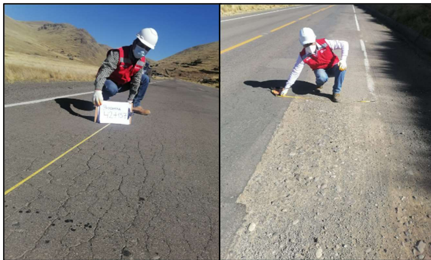
Figura 16: Presencia de piel de cocodrilo y desprendimientos en la carpeta.
