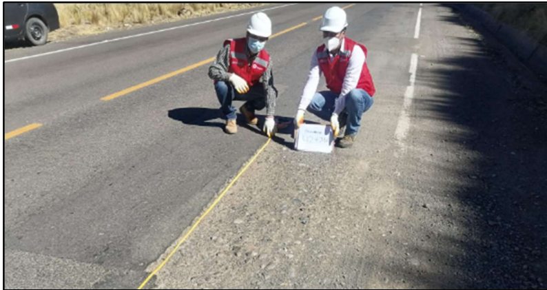
Figura 3: Áreas ligeramente deterioradas en la superficie de la carpeta
