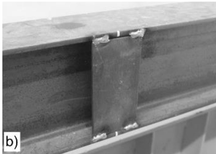
Figura 3. Disposición del refuerzo en la viga IPE, con aplicación de cordones de soldadura espaciados, con la finalidad de tener una unión flexible
