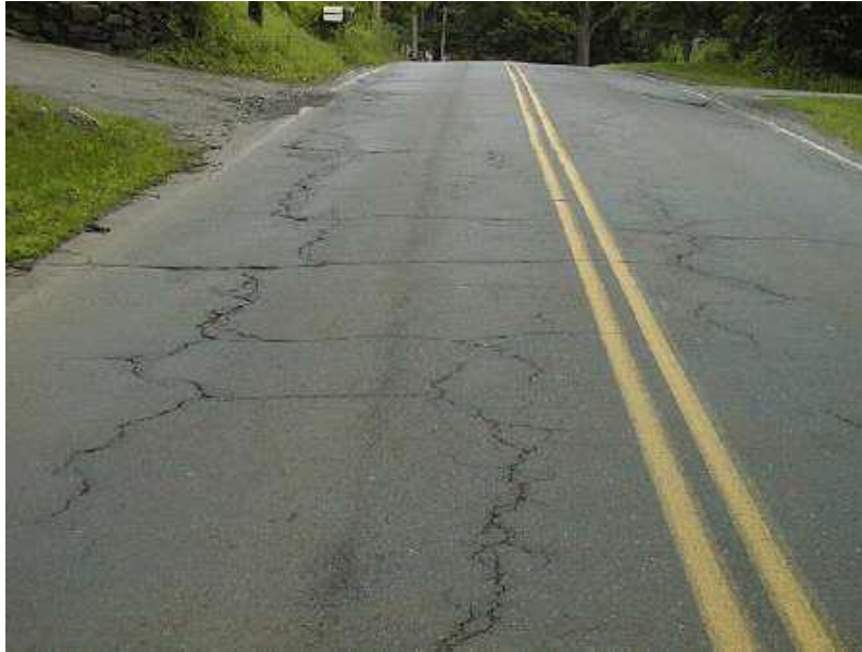
Figura 3. Agrietamiento en bloque (Fuente: ingenieriareal.com)
