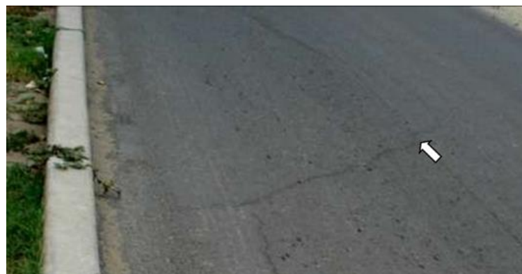
Figura 17. Grieta parabólica (slippage) (Fuente: ingenieriareal.com)
