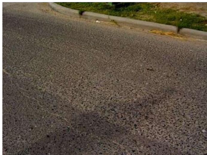
Figura 19. Desprendimiento de agregados (Fuente: ingenieriareal.com )
