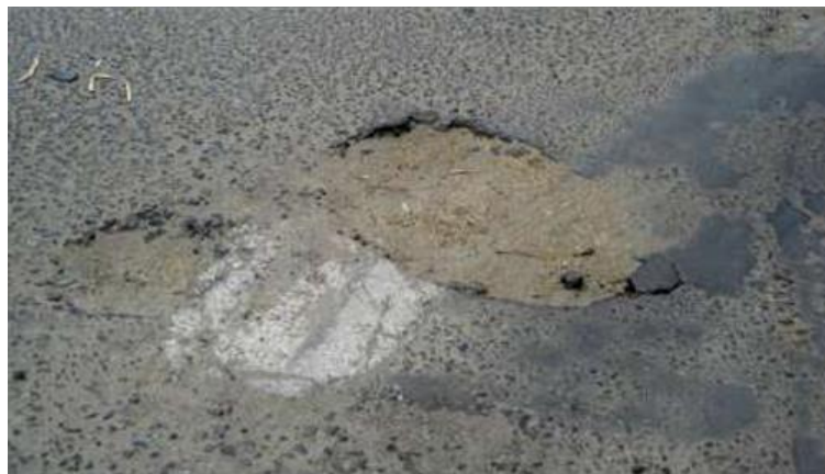
Figura 13. Huecos (Fuente: ingenieriareal.com )
