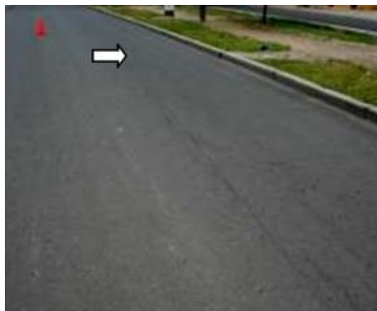
Figura 15. Ahuellamiento (Fuente: ingenieriareal.com)
