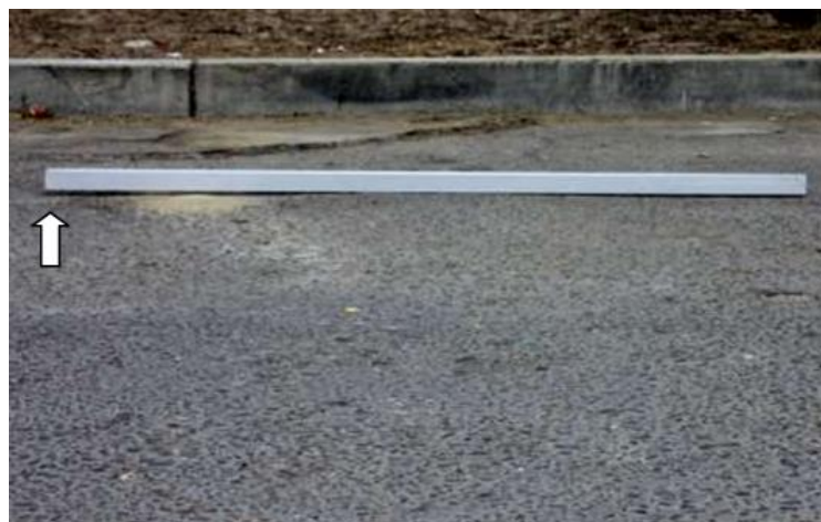
Figura 4. Abultamientos y hundimientos (Fuente: ingenieriareal.com)
