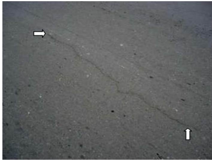
Figura 10. Grietas longitudinales y transversales (Fuente: ingenieriareal.com )
