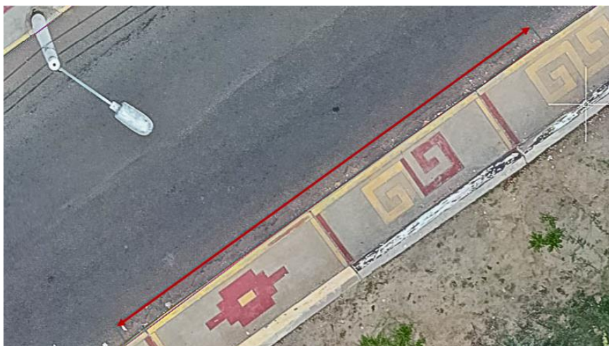
Figura 47. Sección 0+180 - 0+240, Grietas de Borde.
