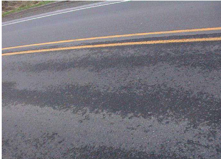
Figura 2. Exudación (Fuente: ingenieriareal.com)
