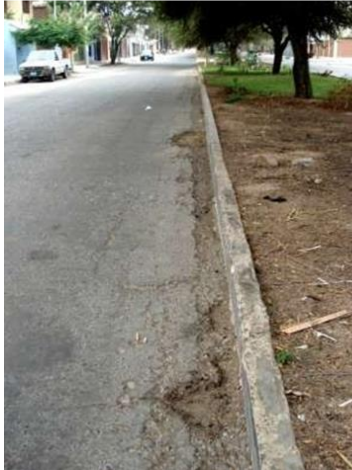
Figura 7. Fisuras de borde (Fuente: ingenieriareal.com)
