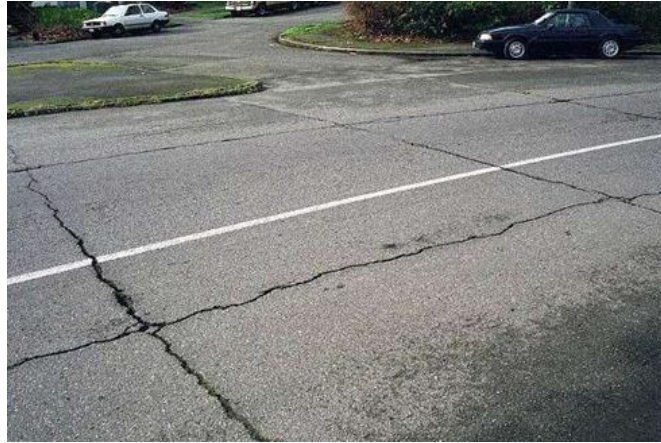
Figura 8. Fisuras de reflexión de junta (Fuente: ingenieriareal.com)
