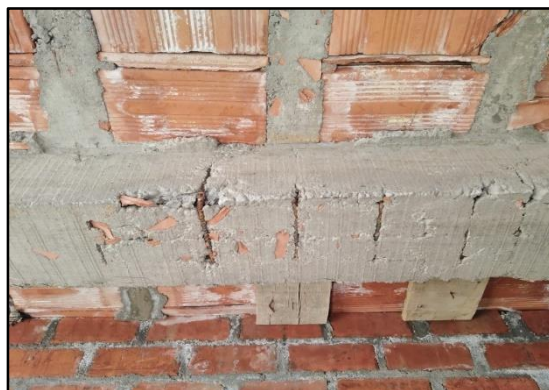
Figura 2. Acero en viga peraltada sin recubrimiento.
