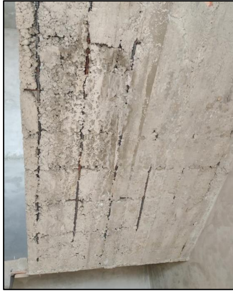
Figura 3. Acero de escaleras sin recubrimiento.
