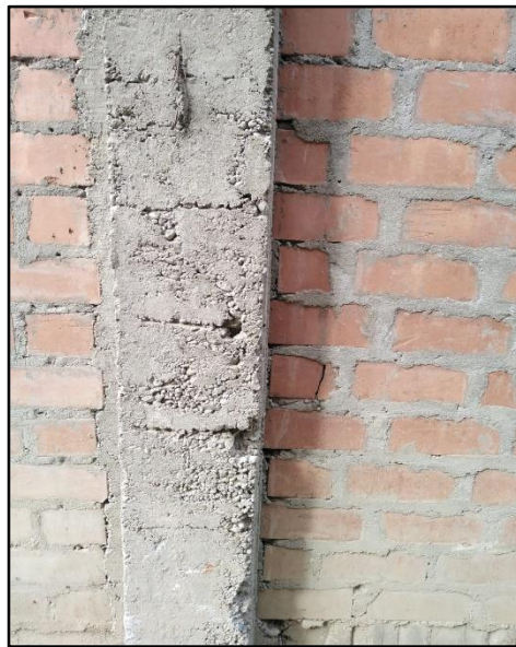
Figura 4. Acero de columna sin recubrimiento.
