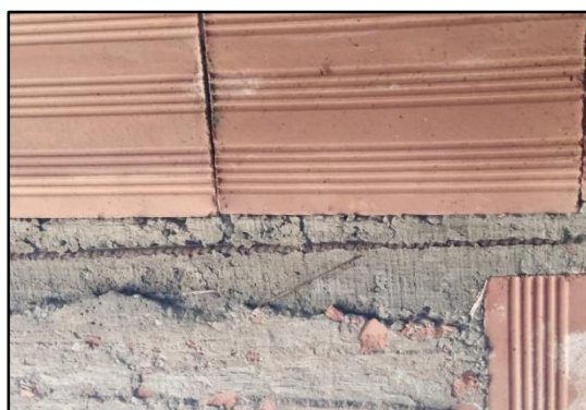
Figura 1. Acero de la vigueta sin recubrimiento.
