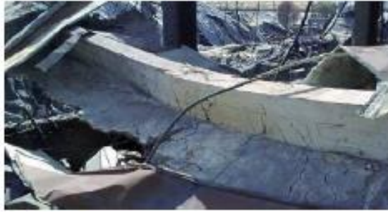
Figura N° 6: Ejemplo de una viga que fue expuesta al fuego
