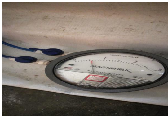
Figura 34. Lectura de un vacuometro dentro del tunel.
