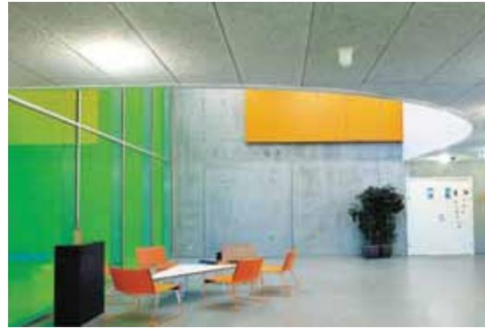
Figura 104. Cielo raso – con juntas visibles Fuente: Cielos Falsos Rasos y Modulares - Corporación de desarrollo tecnológico.
