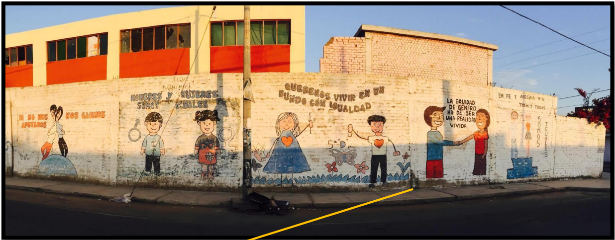
Figura 13. Muro afectado por la oxidación y corrosión.
