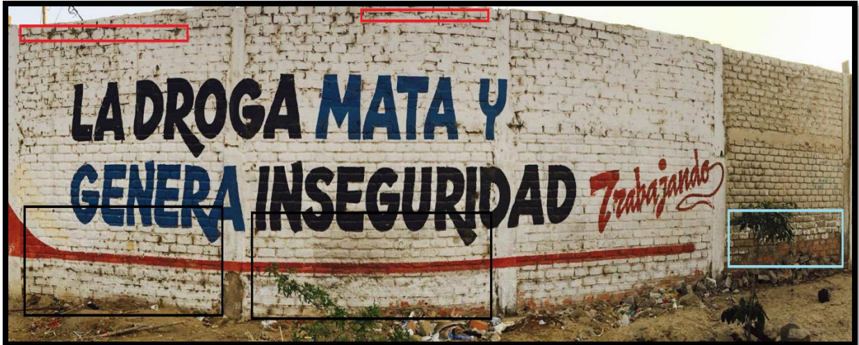
Imagen 6. Esta imagen representa a la unidad de muestra “18”, donde la patología que mayor incidencia en los daños a sus elementos estructurales es la eflorescencia, seguida de la erosión y en menor cantidad la grieta. Se observa que la basura y humedad es algo común y normal en todo el perímetro del cerco, por lo que podemos decir que son los principales factores pertenecientes a las lesiones físicas que sufre el concreto, en la aparición de dichas patologías.
