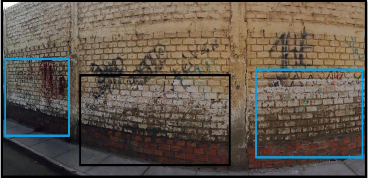
Imagen 4. Verificamos que en la unidad de muestra “15”, la patología predominante o que mayor incidencia tiene en los daños causados a sus elementos estructurales es la erosión.
