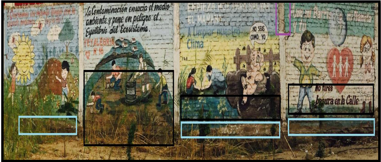
Imagen 7. En unidad de muestra “24”, la patología que mayor incidencia tiene en el deterioro de los elementos estructurales es la eflorescencia, seguida de la erosión y con menor afectación a la estructura la grieta y la desintegración. Hay que tener presente que se presenta abundante vegetación, la cual es causada por la humedad del terreno y en conjunto lograr la aparición de estas enfermedades.
