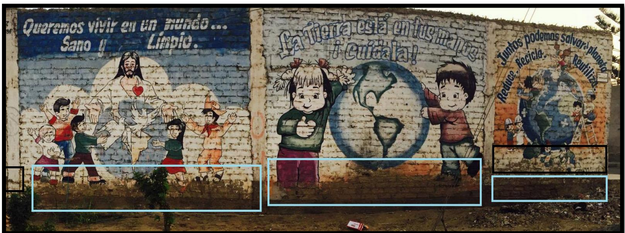
Imagen 7. Se aprecia que el terreno donde se encuentra la unidad de muestra “25”, presenta mucha humedad y suciedad, presentando patologías donde la erosión es la que mayor daño y deterioro causa a los elementos estructurales, seguida de la eflorescencia y en menor proporción la grieta.
