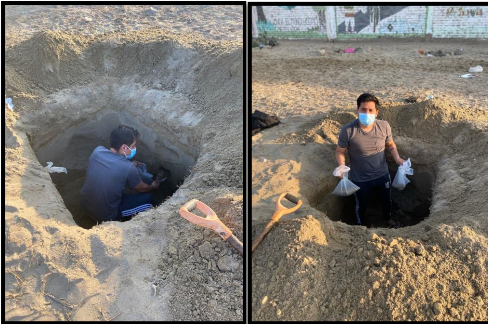
Imagen 2. Una vez ya excavado, se procedió a extraer las muestras no alteradas, las cuales se llevarán a un laboratorio para su estudio y así tener con más claridad de cuál es el estado químico y físico del terreno.
