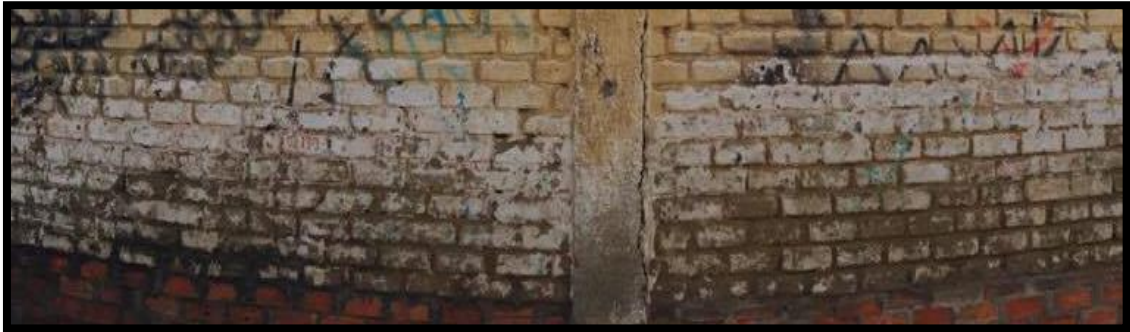
Figura 12. Muro afectado por la eflorescencia.
