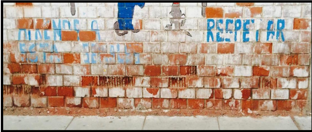
Figura 10. Muro afectado por la erosion.
