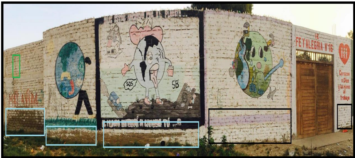
Imagen 8. Apreciamos que en la unidad de muestra “19”, la patología que más daña a los elementos estructurales es la erosión, seguida de la eflorescencia y en un menor grado de incidencia de daño a la fisura. La maleza en estos tramos, son muy comunes.
