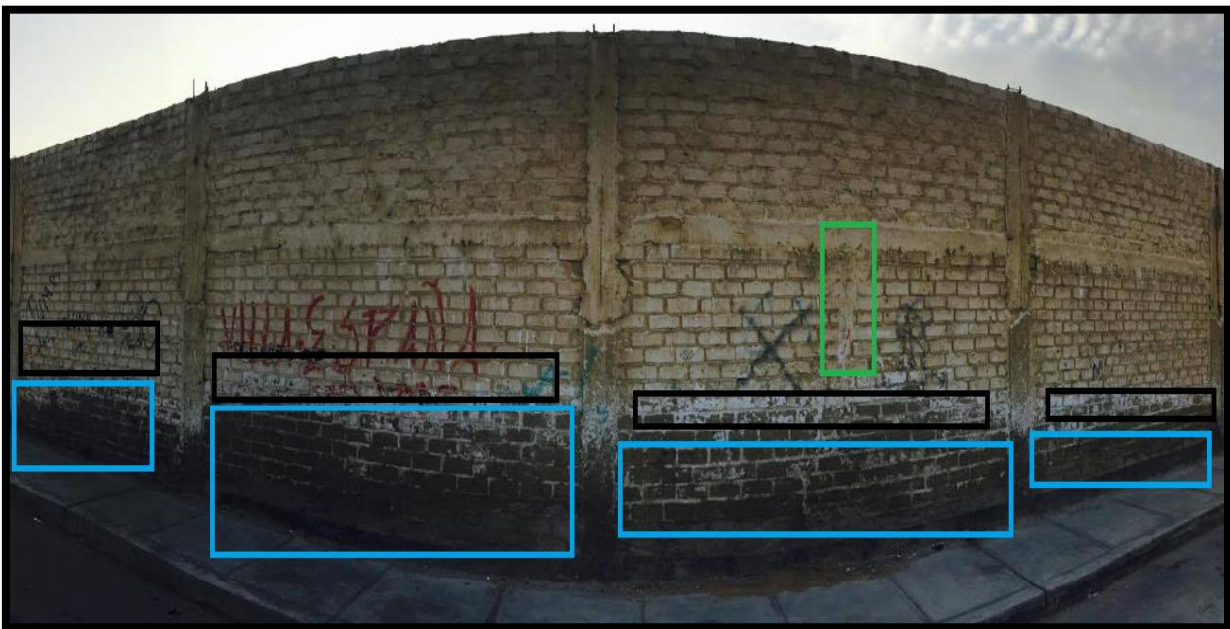
Imagen 5. En la unidad de muestra “12”, la erosión es la patología que tiene mayor incidencia en el deterioro de los elementos estructurales seguida de la eflorescencia y con menor daño causado a esta unidad esta la fisura.
