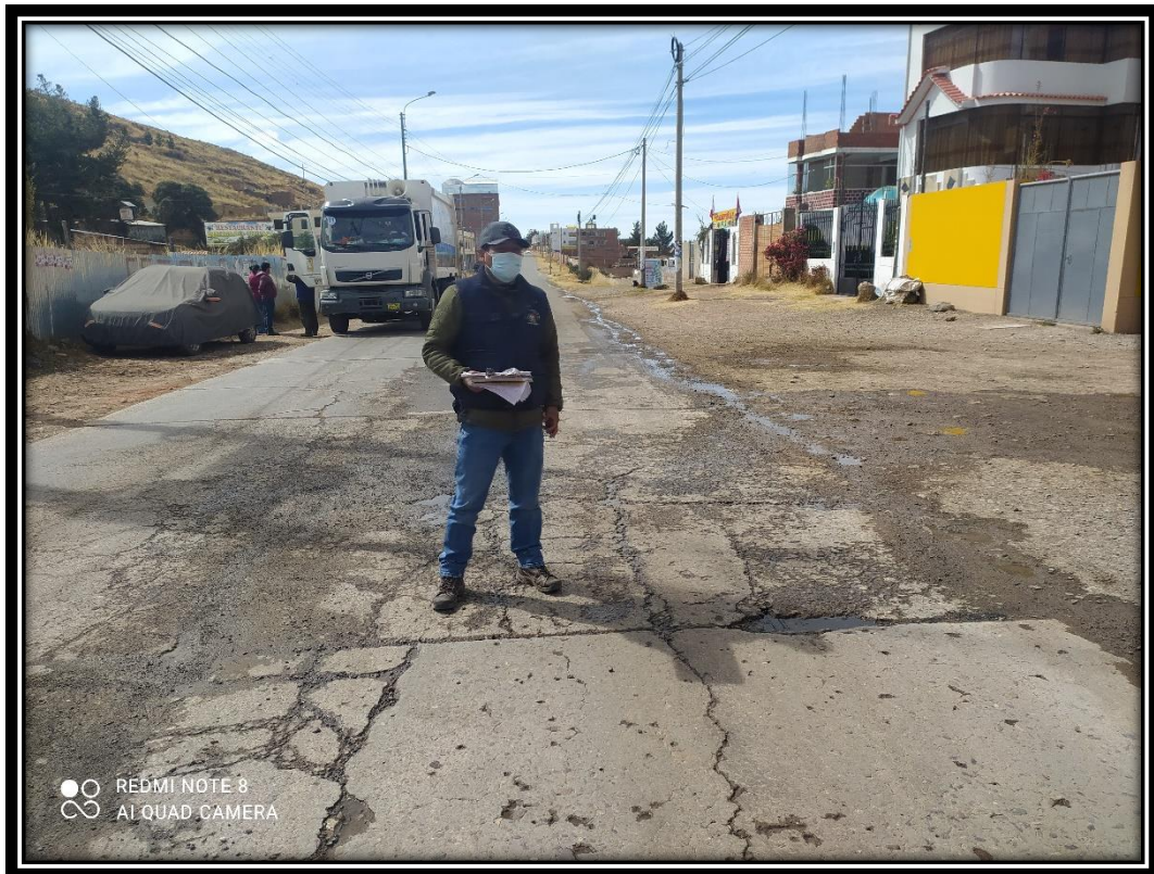
Figura. fotografía tipo de falla – 24 grieta de durabilidad
