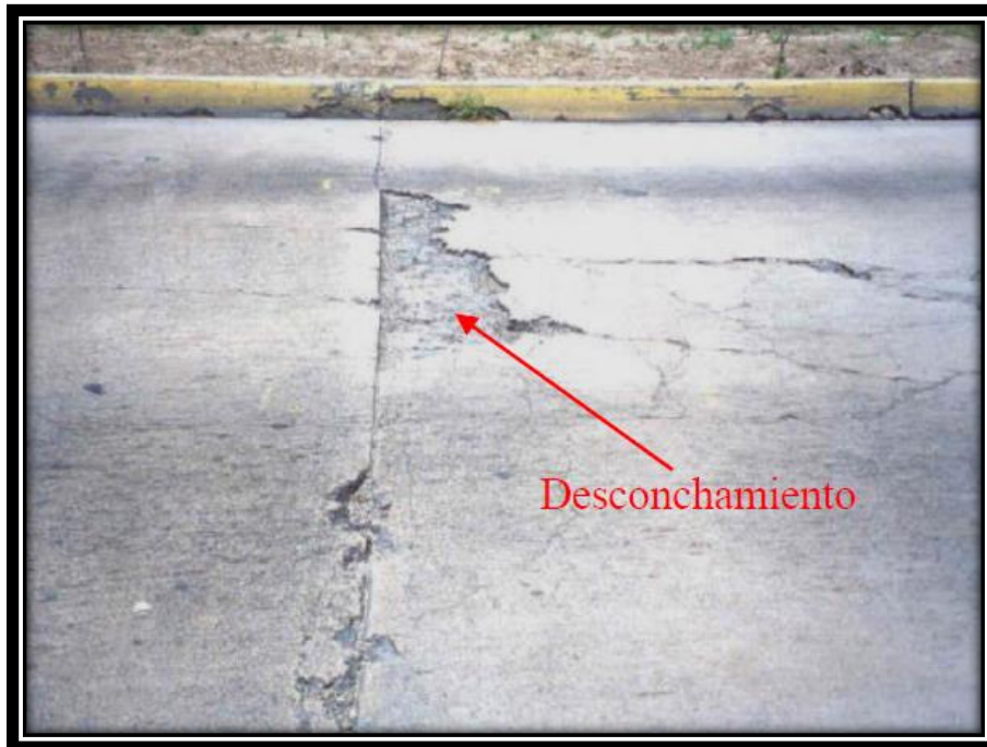
Figura. 24 Desconchamiento, mapa de grietas, craquelado
