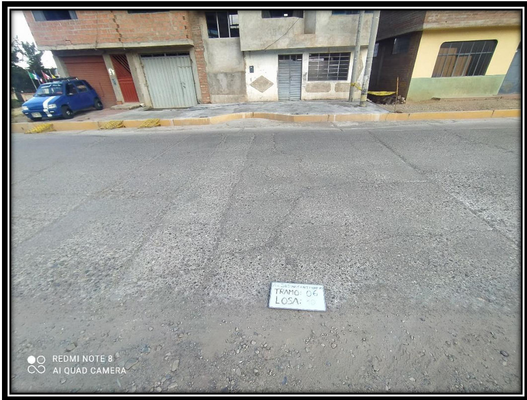
Figura. fotografía tipo de falla – 29 parcheo grande
