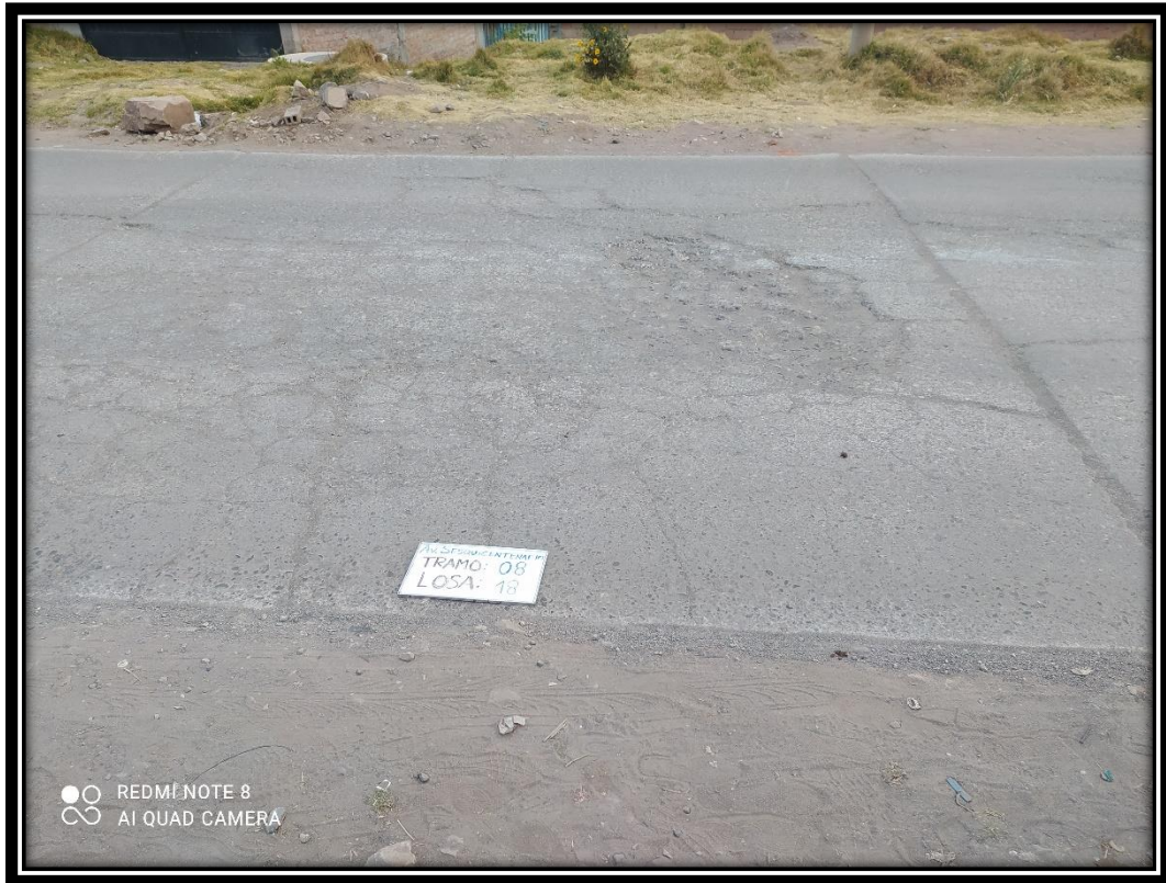
Figura. fotografía tipo de falla – 26 sello de junta no existe
