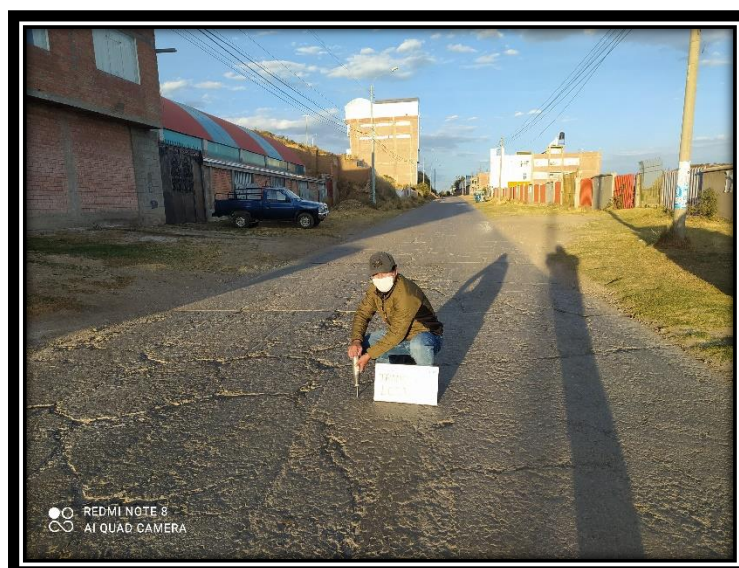
Figura. 41a ensayo de resistencia con esclerómetro
