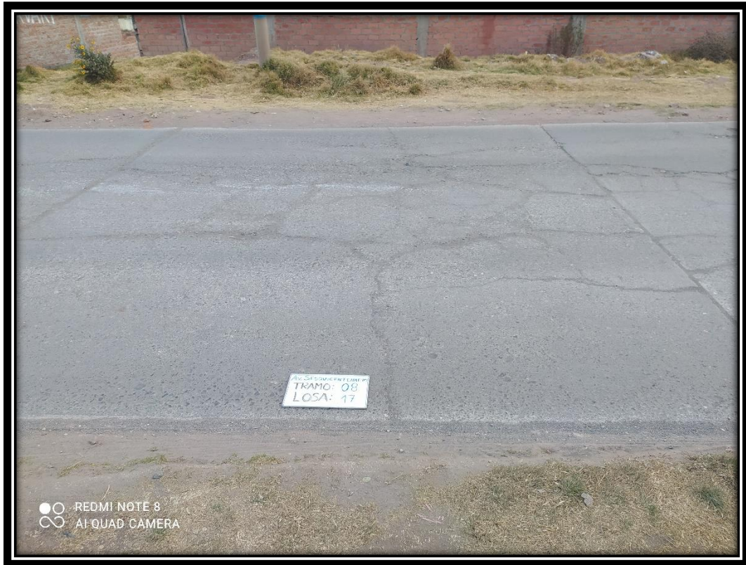
Figura. fotografía tipo de falla – 27 desnivel carril / berma
