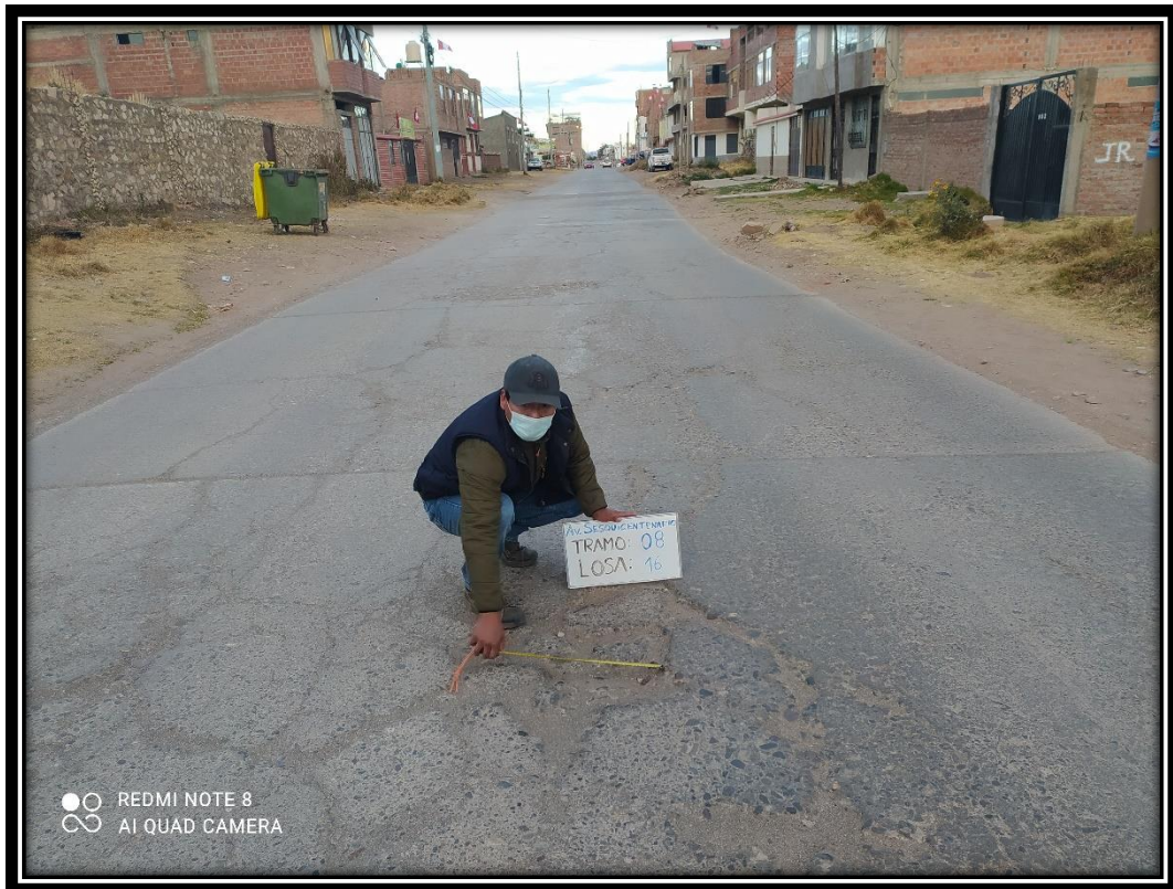
Figura. fotografía tipo de falla – 34 punzonamiento
