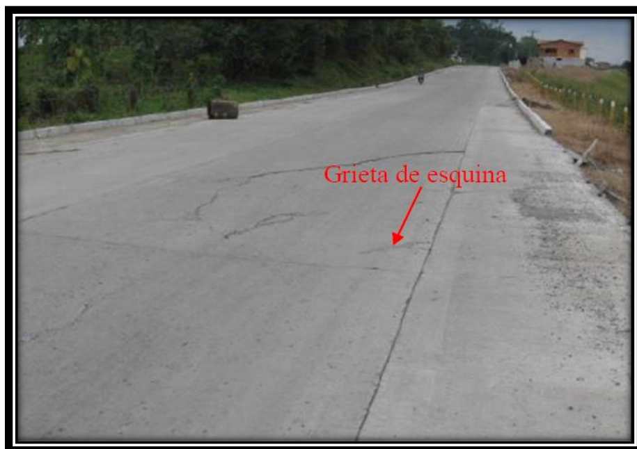
Figura. 9 Grieta de esquina
