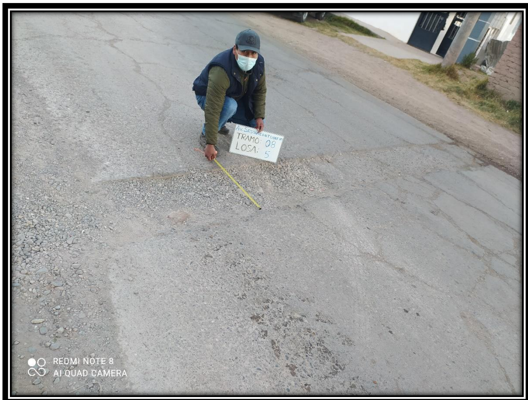
Figura. fotografía tipo de falla - 39 descascaramiento de junta
