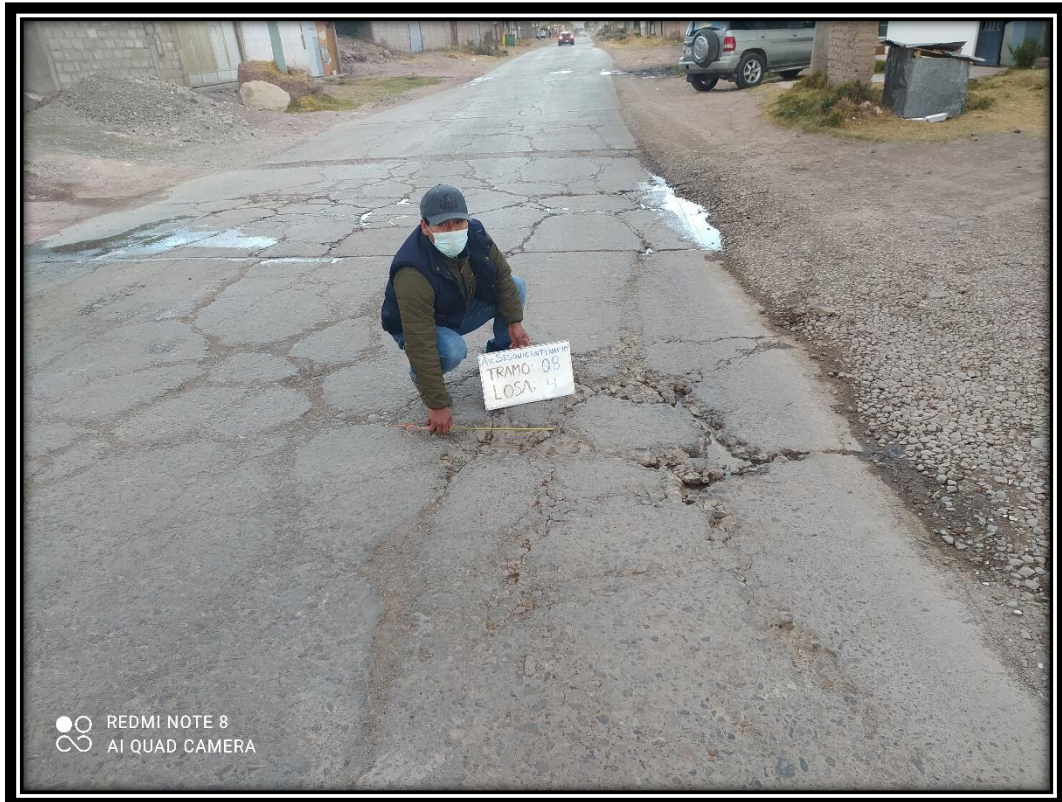
Figura. fotografía tipo de falla – 34 Punzonamiento y 28 grietas lineales
