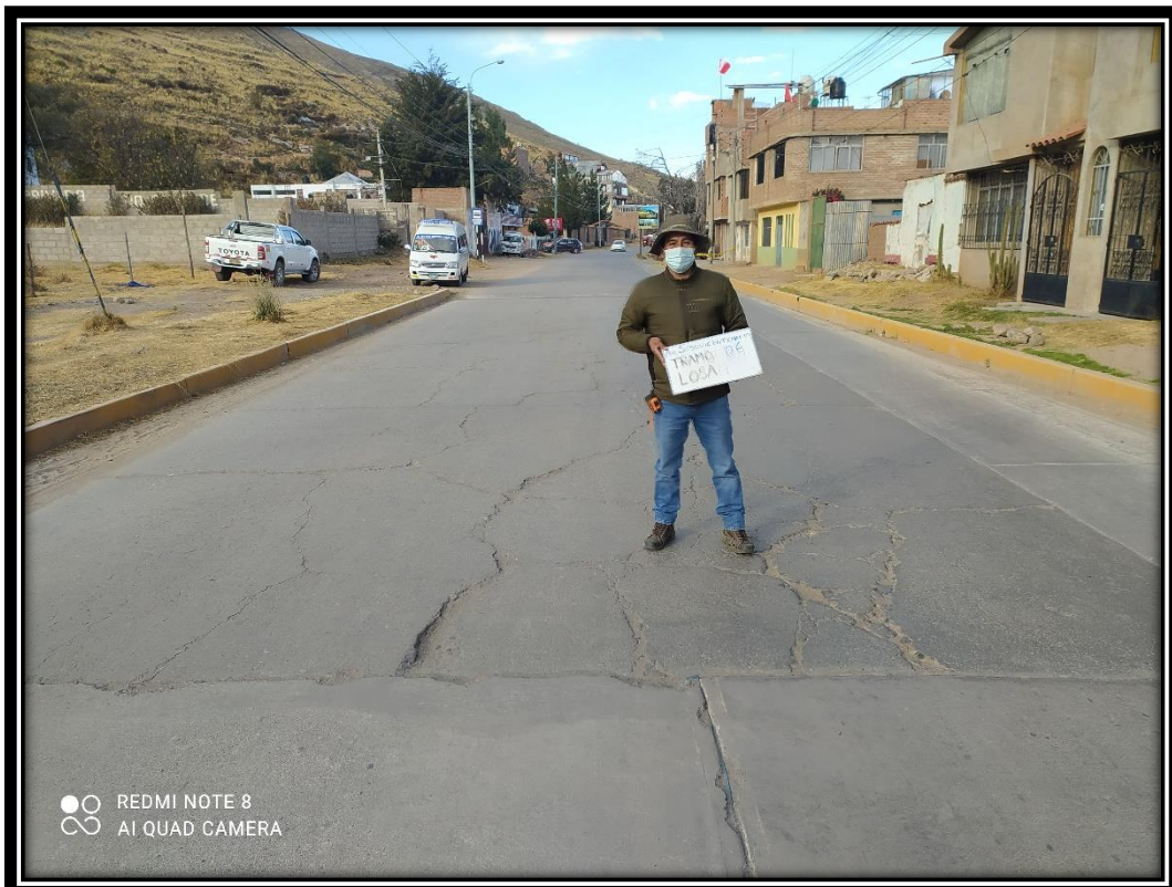
Figura. fotografía falla – inicio de pavimento rígido tramo 01 al 11
