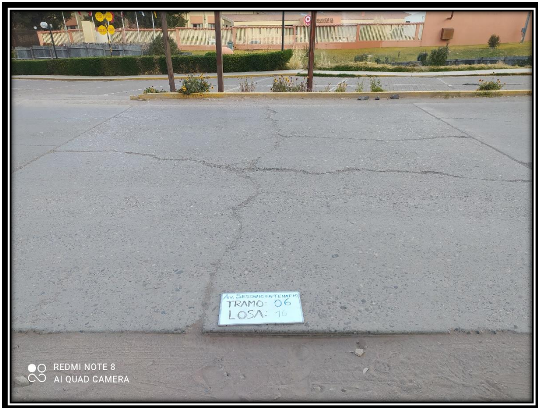
Figura. fotografía tipo de falla – 23 losa dividida
