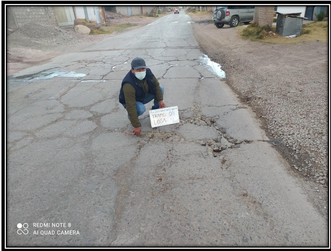
Figura. 1 estado actual del pavimento rígido existente
