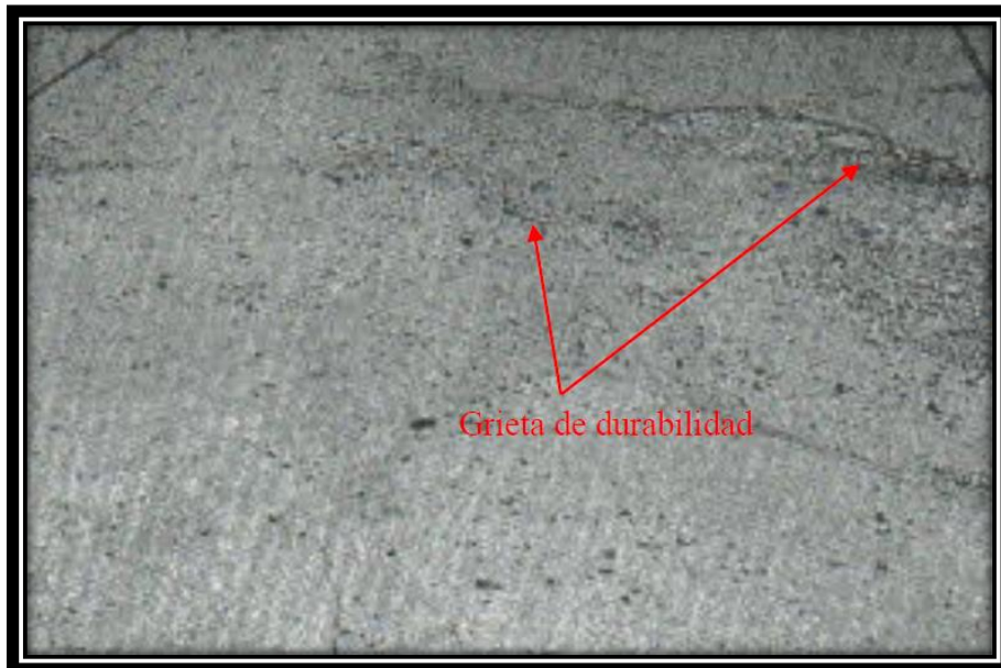
Figura. 11 Grieta de durabilidad "D"
