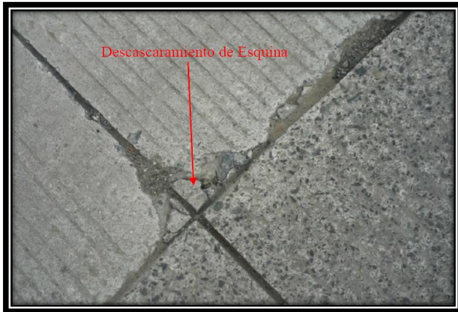
Figura. 26 Descascaramiento de esquina
