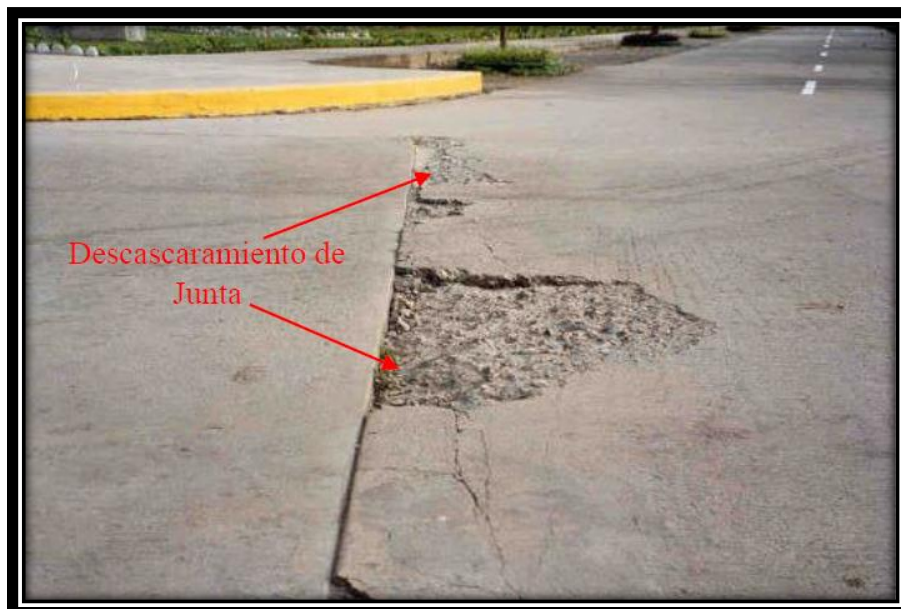
Figura. 27 Descascaramiento de junta
