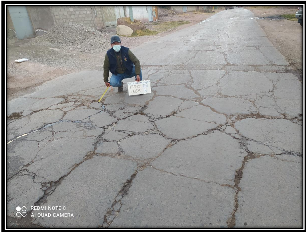
Figura. fotografía tipo de falla – grietas lineales, parcheo pequeño, etc
