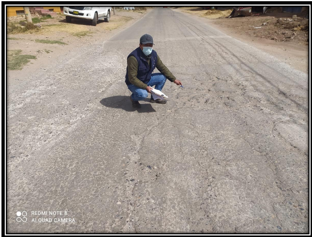
Figura. fotografía tipo de falla – 34 punzonamiento y pulimento de agregados
