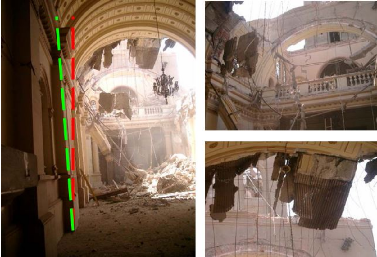
Figura 1.7: Pérdida de alineamiento y estructura de arcos
