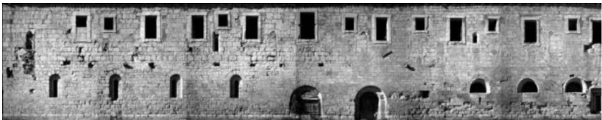
Figura 2.11: Desgastes, roturas y humedades del Monasterio de Santa Maria de Valbuena. Tomado de (Alonso, 2010)
