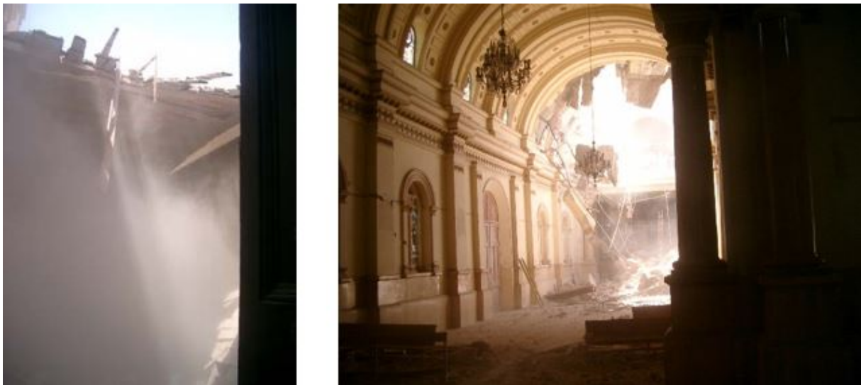
Figura 1.8: Desplome de la nave central
