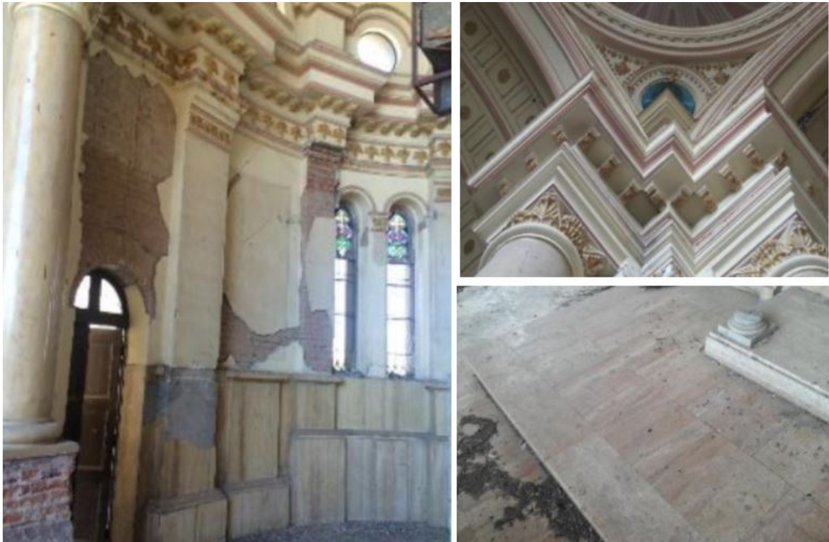
Figura 4.5: Vista del muro curvo del ábside. Nótese el zócalo de travertino a desmontar y parte de los vitrales de las V07 ( imagen de la izquierda). Vista de las pechinas y los elementos decorativos a desmontar. Pieza a Staccar ( imagen de la derecha superior). pasos y contrapasos de mármol a codificar y desmontar para su reposición (imagen de la derecha inferior)
