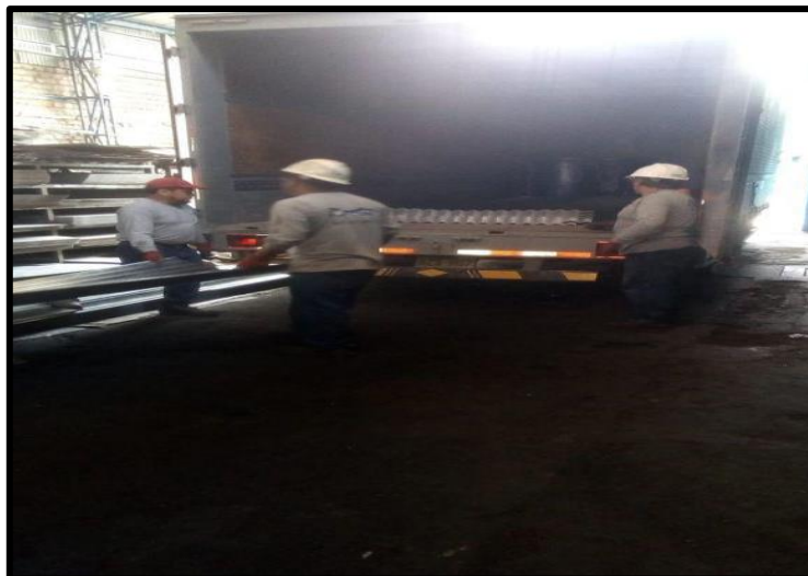
Figura 12. Falta de mascarillas y EPPs
