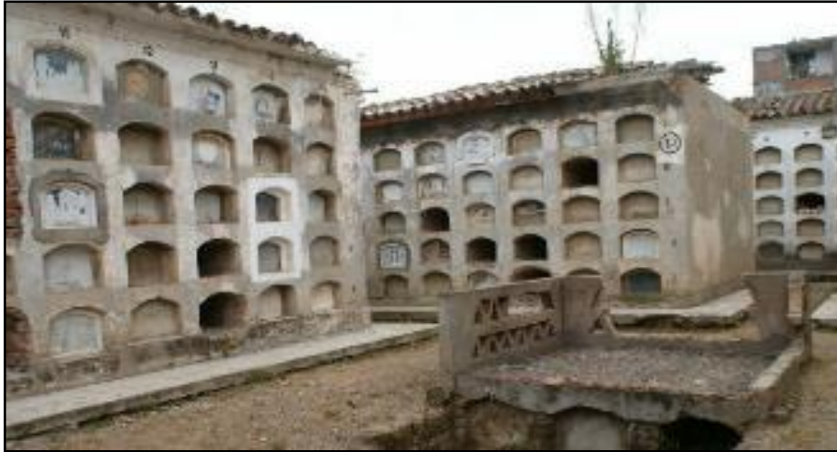
Figura N° 4: Pésimo estado de mantenimiento, podría generar una crisis sanitaria local.
