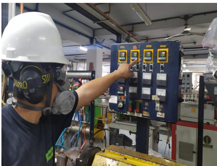
Figura 23. Inspección de tablero eléctrico. Fuente: elaboración propia.
