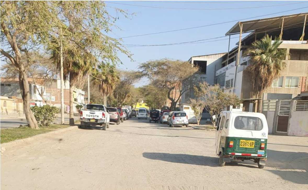
Figura 3. Estado de la Avenida Grau Progresiva 0+200
