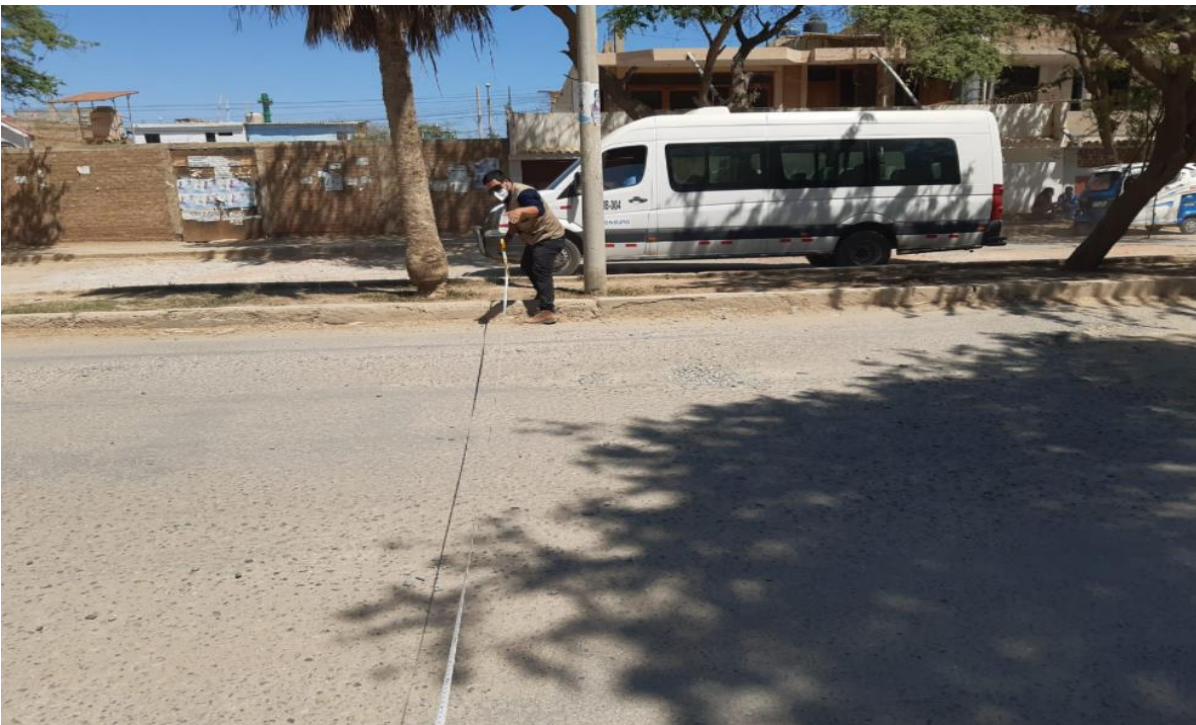
Figura 4. Estado de la Avenida Grau Progresiva 0+200
