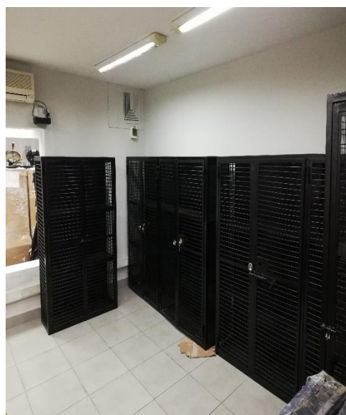
Figura 27. Almacén después de la ejecución 3ra “S”
