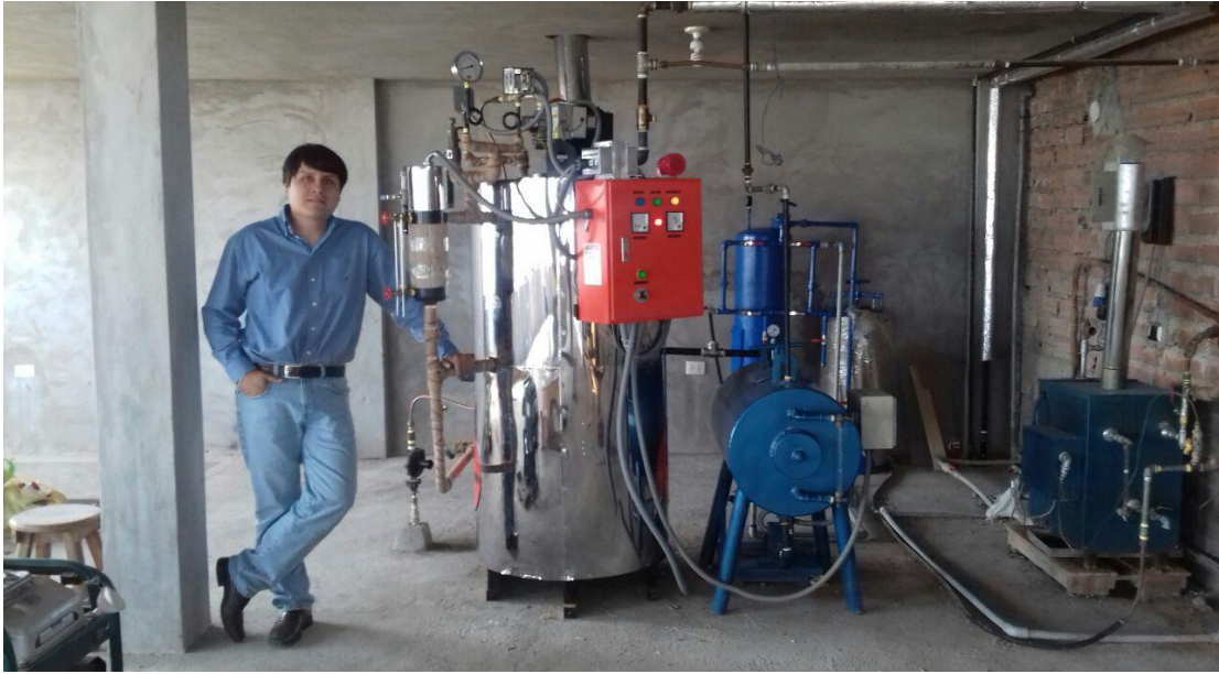
Figura N° 9: Sala de calderas
