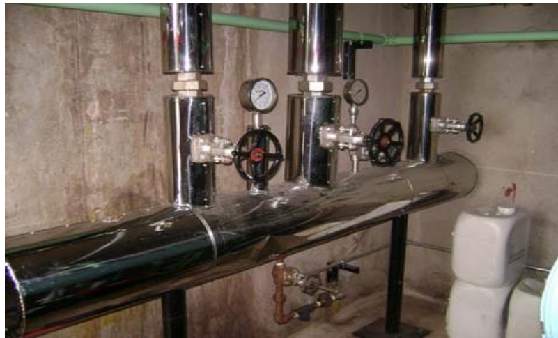
Figura 2. Cabecero distribuidor de vapor de llegada y salida.
