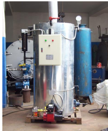
Caldera de vapor 02
